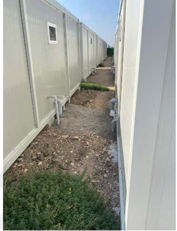
Şekil 3.10. Konteynerlerin altyapı bağlantısı (AFAD röportajı, 2023).
