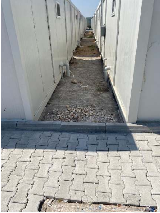
Şekil 3.9. Konteynerlerin altyapı bağlantısı (AFAD röportajı, 2023).
