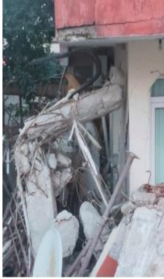
Şekil 2.9. Yapı elemanı kaynaklı hasar, Hatay (AFAD, 2023).
