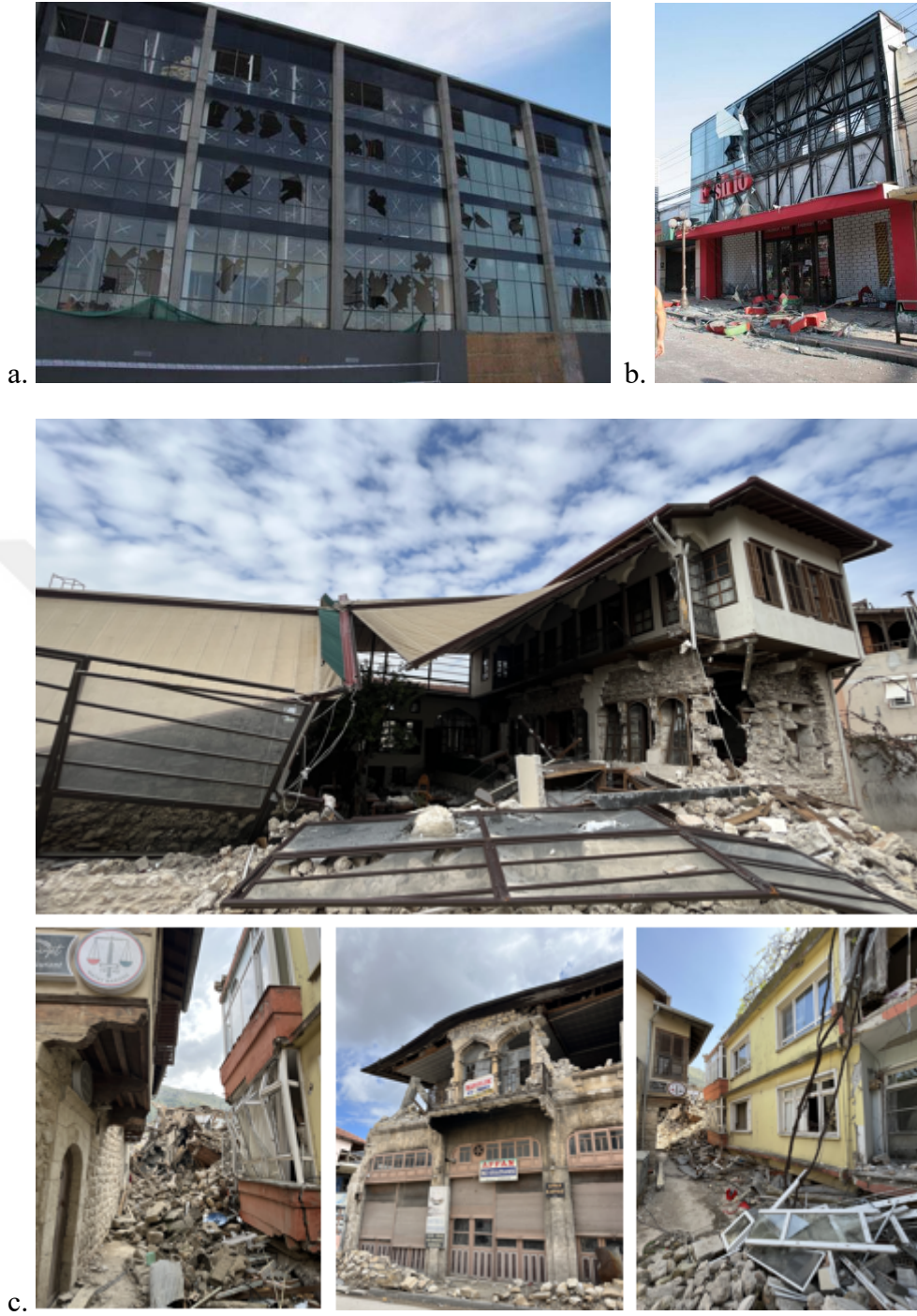
Şekil 2.6. a) 2010 yılında Şili’de meydana gelen 8.8 büyüklüğündeki depremde oluşan cam hasarları (FEMA 2011); b) Şili Depremi’nde yapının yanındaki yapıyla çarpışmasıyla oluşan cam hasarları (FEMA 2011); c) 6 Şubat 2023 depremleri – Hatay (Melis Seyfettinoğlu kişisel arşivi)
