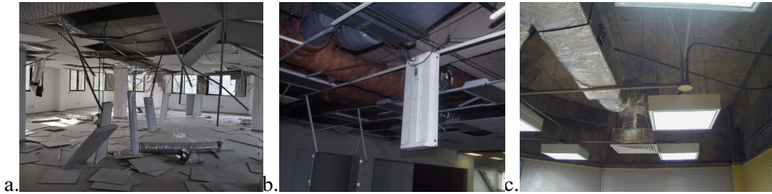
Şekil 2.40. a) 2010 Haiti Depremi'nde güvenlik telleri olmadan asma tavana asılan gömülü aydınlatmaların durumu (FEMA 2011); b) 1994 Northridge Depremi'nde yeterli desteklere sahip olmayan gömülü aydınlatmaların bağlı oldukları kenar boyunca sarkması (FEMA 2011); c) 2001 Peru Depremi'nde tavana dört askı cıvatasıyla bağlı olan gömülü aydınlatmaların zarar görmemesine rağmen, braketsiz asma tavan sisteminin çökmesi (FEMA 2011)
