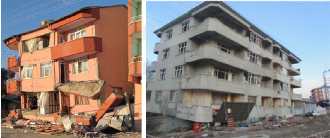
Şekil 2.16. Deprem etkisiyle oluşan yumuşak kat hasarları (Anonim 15)
