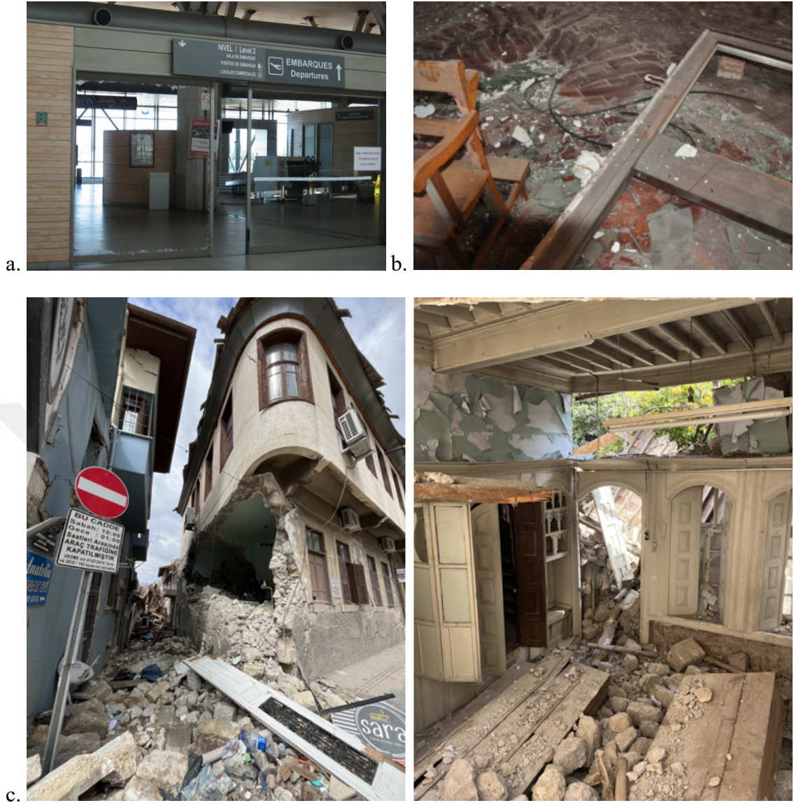
Şekil 2.13. a) 2010 yılında Şili’de meydana gelen depremde havaalanındaki camlı kapıların zarar görmesi (FEMA 2011); b) Ahşap çerçeveli kapının zarar görmesi (FEMA 2011); c) 6 Şubat 2023 depremleri – Hatay (Melis Seyfettinoğlu kişisel arşivi)
