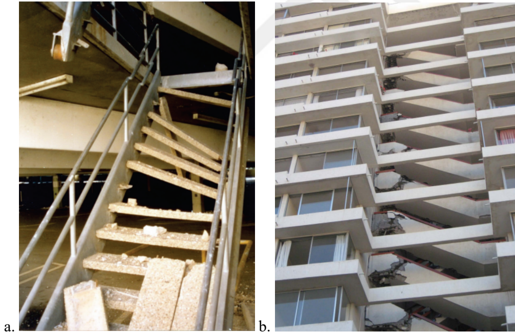
Şekil 2.32. a) 1994 yılında 6.7 büyüklüğünde meydana gelen Northridge Depremi'nde kayma nedeniyle hasar gören merdiven (FEMA 2012); b) 2010 yılında 8.8 büyüklüğünde meydana gelen Şili Depremi'nde merdivenlerin katlara rijit bir şekilde bağlanmasıyla payanda gibi davranıp hasar görmesi (FEMA 2011)
