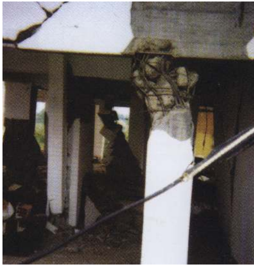
Resim 4.2. 1999 Marmara depreminde görülen taşıyıcı sistem düzensizliği hasarı[85]
