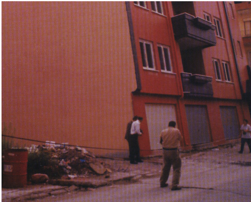
Resim 4.1. 1999 Marmara depreminde görülen sıvılaşma hasarı [85]
