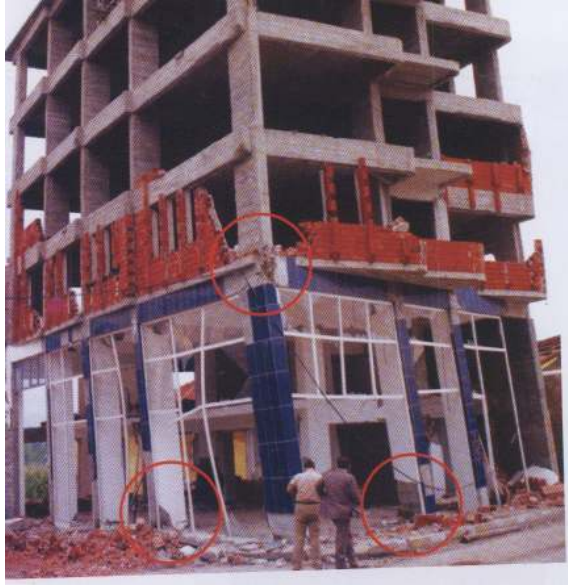
Resim 4.4. 1999 Marmara depreminde görülen yumuşak kat hasarı [85]
