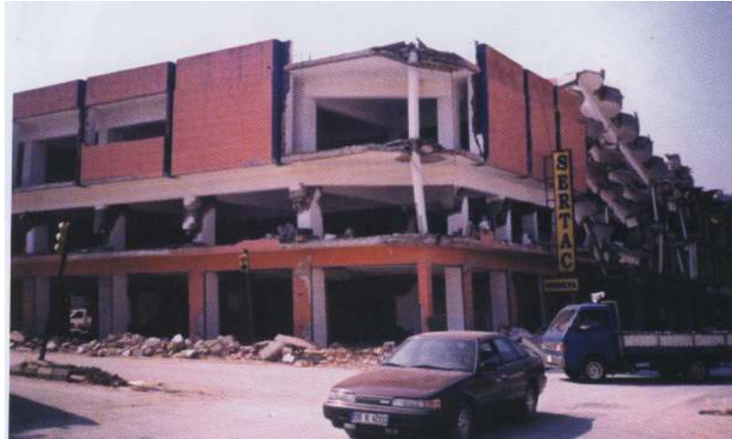
Resim 4.5. 1999 Marmara depreminde görülen kısa kolon hasarı [85]
