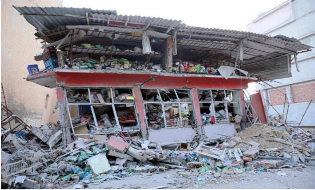
Şekil 6. Deprem İle Kendi Üstüne Çökmüş Bir Yapı (SBB, 2023)
