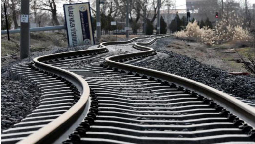
Şekil 15. Depremin Tren Yolu Hattında Meydana Getirdiği Hasar (SBB, 2023)
