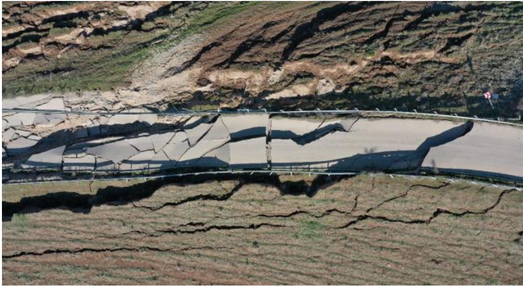
Şekil 16. Karayolunda Depremin Yol Açtığı Hasar (SBB, 2023)
