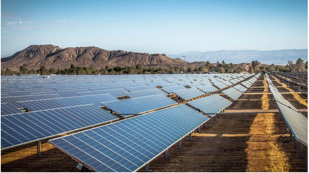
Şekil 3.3. Fotovoltaik güneş panelleri (Tubitak, 2021)
