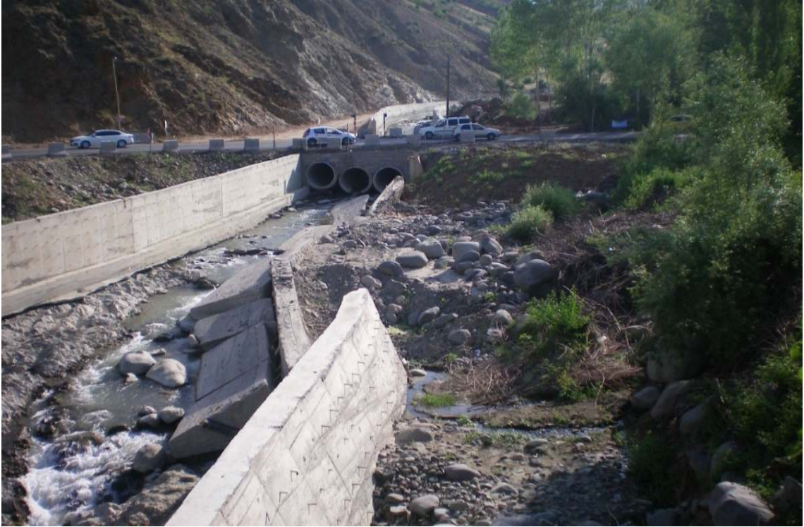
Şekil 1.5. Tahrip olan taşkın kontrol tesisi
