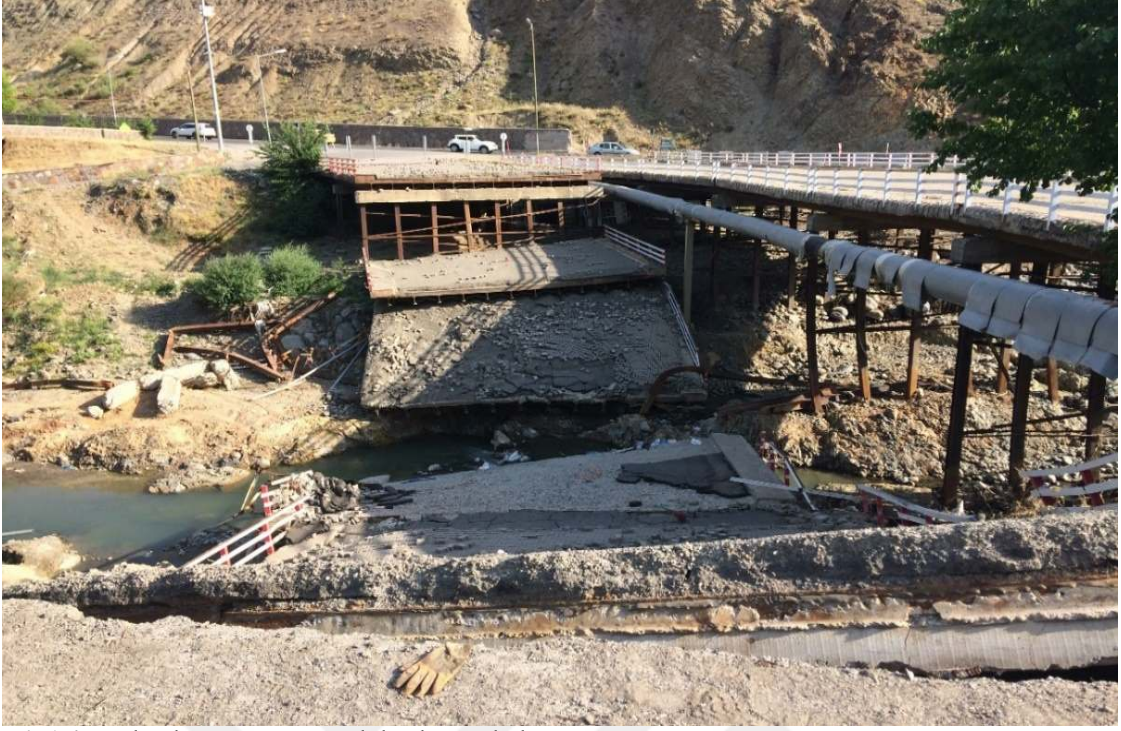
Şekil 1.4. Taşkindan zarar gören yıkılan karayolu köprüsü
