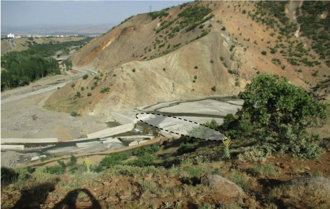
Şekil 1.3. Taşkindan zarar gören mansaptaki tersip bendi
