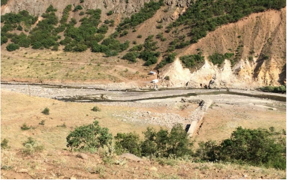
Şekil 1.2. Taşkindan zarar gören orta kısımdaki tersip bendi
