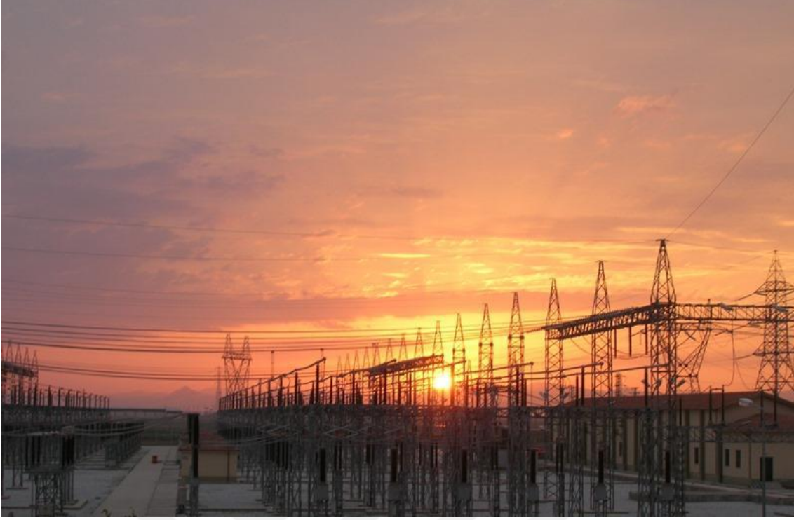
Şekil 1.3: Trafo Merkezi (URL 6, 2019)
