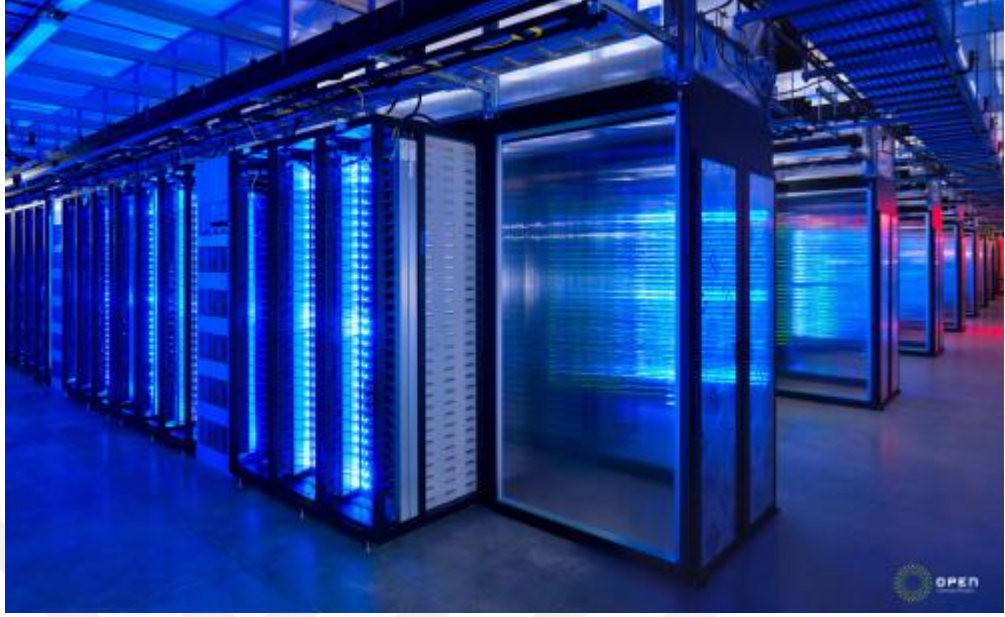
Şekil-1.10: Veri Merkezi Gösterimi (Data Center Technology Guide, 2013:53)
