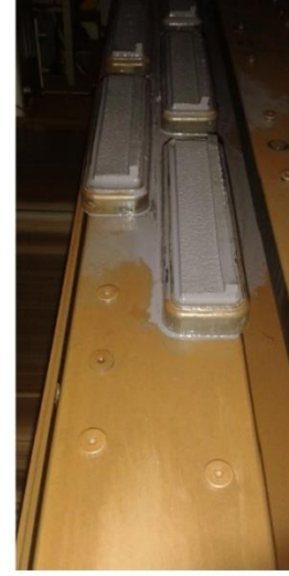
Şekil 34– Aşırı kirlenmiş boya tankları
