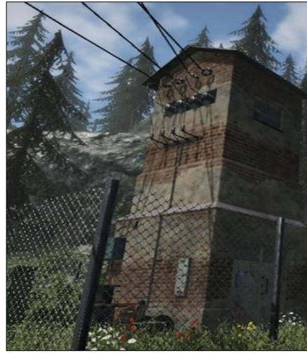
Görsel 48: Contraband Police Trafo Merkezi
