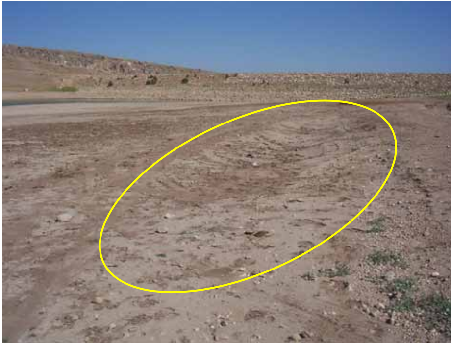
Şekil 4.13. Rezervuar alanında sağ yamaçtaki oturma
