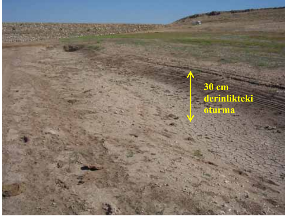
Şekil 4.14. Rezervuar alanında oluşan 30 cm derinlikteki oturma
