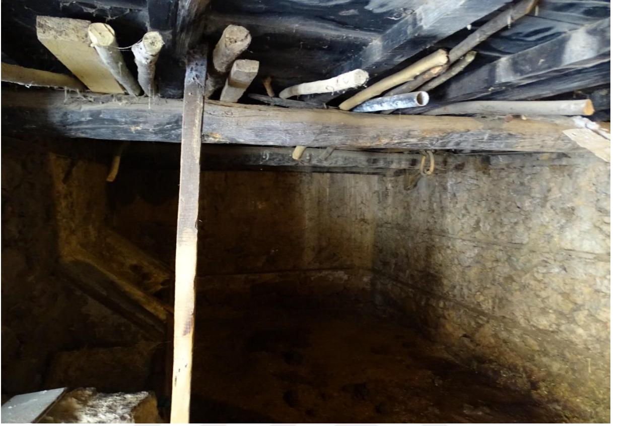
Fotoğraf 2.14 Alacami Mahallesi Meskenlerinde Ahır Örneği (17.02.2018)
