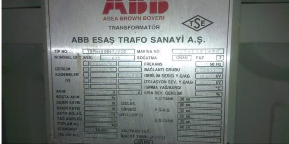
Resim 6.5. Ölçüm noktası 3, transformatör etiket değerleri
