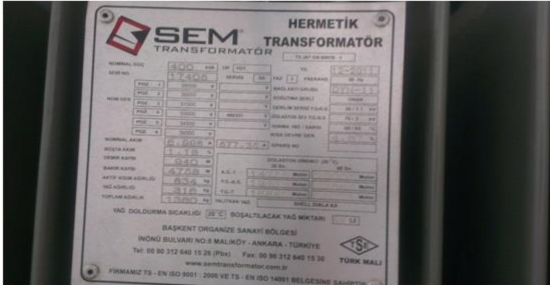
Resim 6.4. Ölçüm noktası 2, transformatör etiket değerleri
