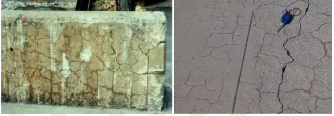
Şekil 2.8. ASR' nin etkisi altında kalan betonlarda gözlenen bozulmalar. İzmir Adnan Menderes Havalimanı pist ve taksi yolu betonunda oluşna ASR çatlakları
