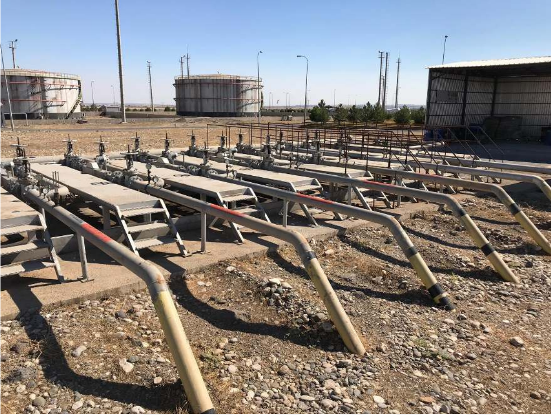
Şekil 3.8. Üretim hatlarının toplanarak tek hatla birleştirildiği Kurkan sahası üretim manifoldu
