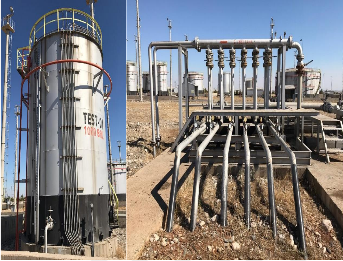
Şekil 3.14. Kuyunun performans testinin yapıldığı test tankı ve kuyunun test tankına alınmasını sağlayan test manifoldu
