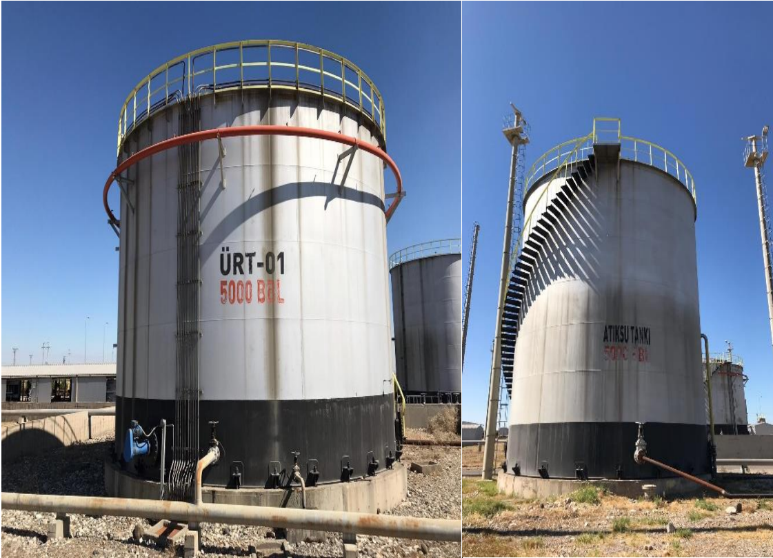
Şekil 3.12. Petrolün depolandığı üretim tankı (solda), suyun depolandığı atık su tankı (sağda)
