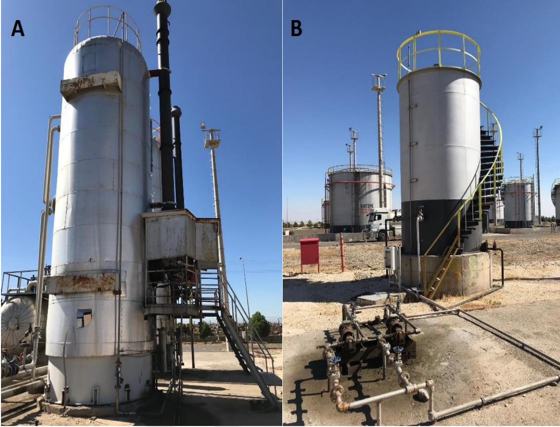
Şekil 3.10. Motorinle çalışan Kırtepe sahasındaki dikey EMK (A), motorin tankı (B)
