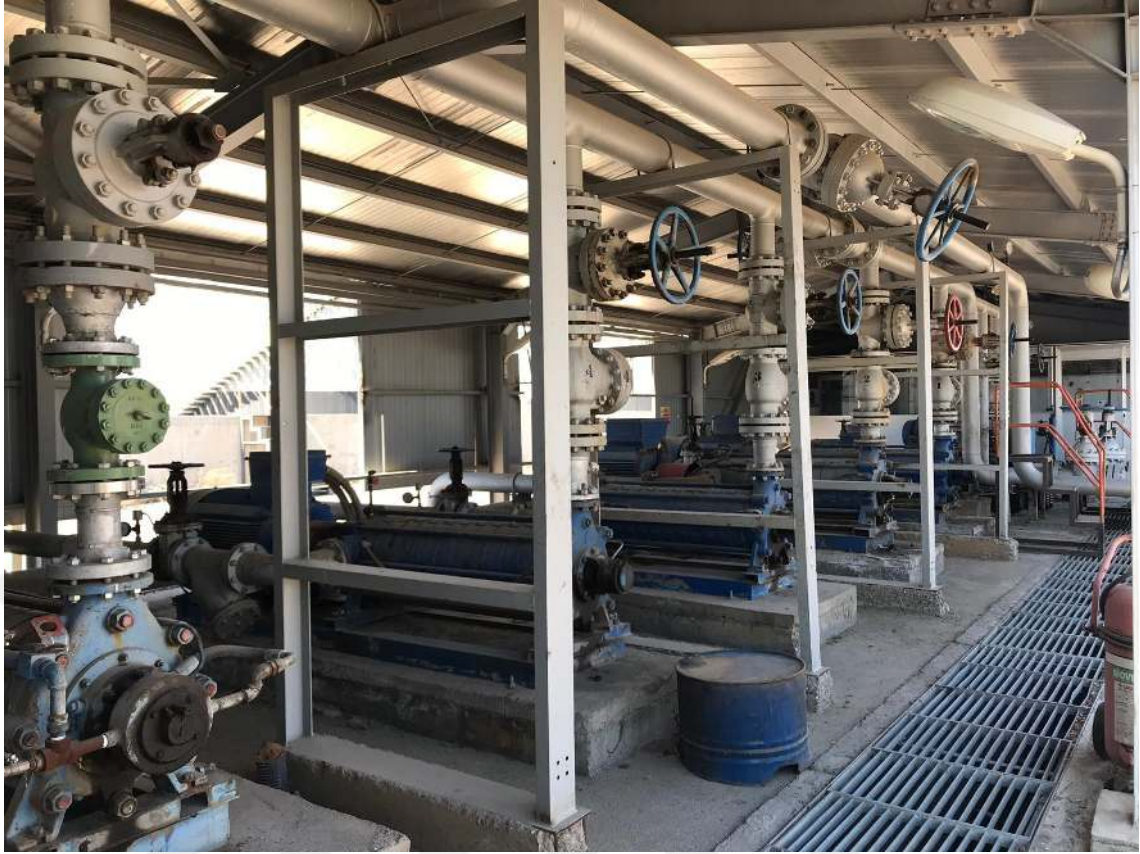
Şekil 3.13. Petrol ve suyun pompalandığı kademeli pompalar
