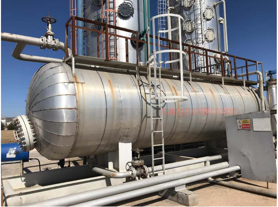
Şekil 3.9. Kırtepe sahasında bulunan serbest su ayırıcısı (SSA)
