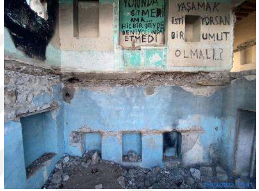
Şekil 4.98 Z01 mahali tavan ahşap kayıpları
