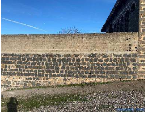
Şekil 4.122 Avlu duvarı üst kotu muhdes bims
