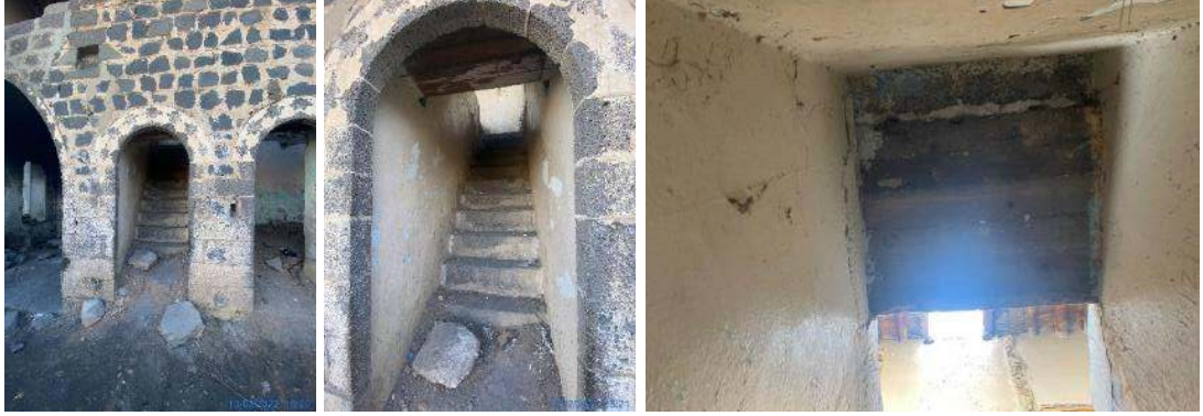
Şekil 4.21 a) Z03 merdiven girişi b) Z02 merdiven basamakları c) Z03 merdiven tavanı sal taşı
