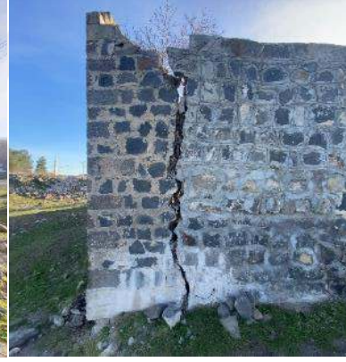
Şekil 4.64 Yapı kuzey cephesi hasarları
