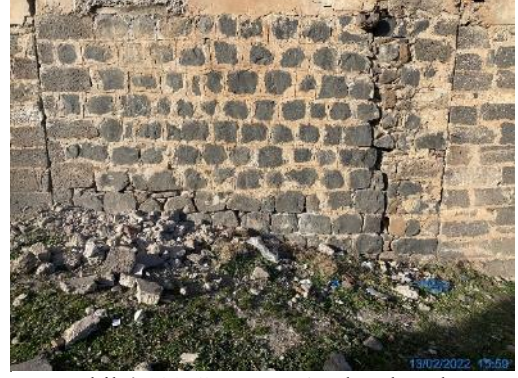
Şekil 4.102 Güney cephe derz boşalması
