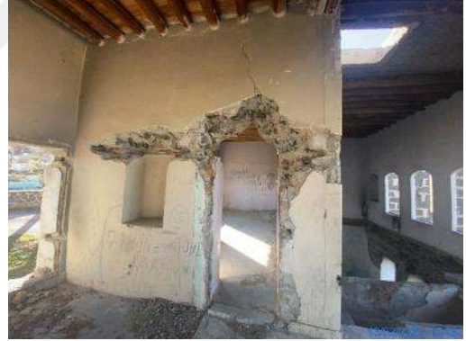
Şekil 4.104 K02 eyvan sıva dökülmesi
