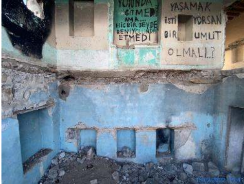
Şekil 4.103 Z01 sıva dökülmesi
