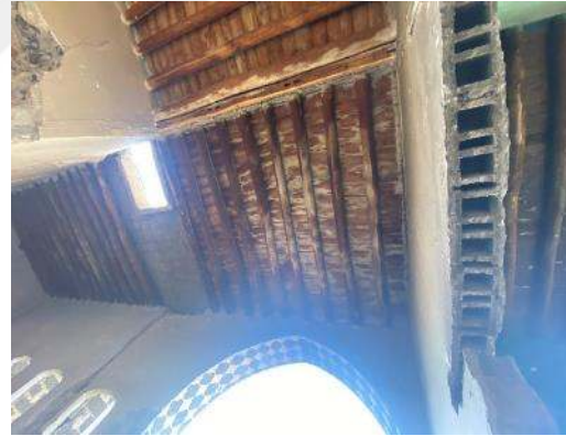
Şekil 4.126 Çatlamış tavan kirişleri
