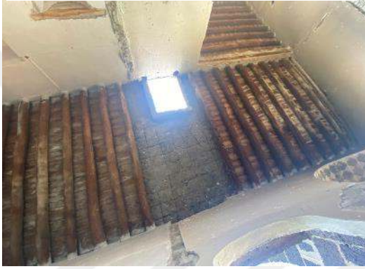
Şekil 4.97 K02 mahali tavan ahşap kayıpları
