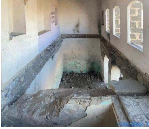
Şekil 4.95 Z04 mahali tavan ahşap kayıpları
