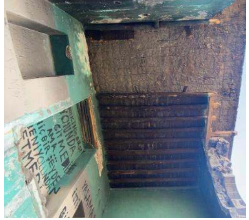
Şekil 4.96 K01 mahali tavan ahşap kayıpları
