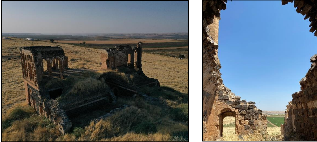
Şekil 4.50 Döşemelerde meydana gelen çökmeler
