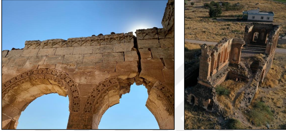
Şekil 4.49 Yapıda meydana gelen eksenel kaymalar ve yıkılmış duvarlar
