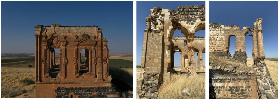
Şekil 5.7 Yapının tamamlanmadığını gösteren duvar parçaları
