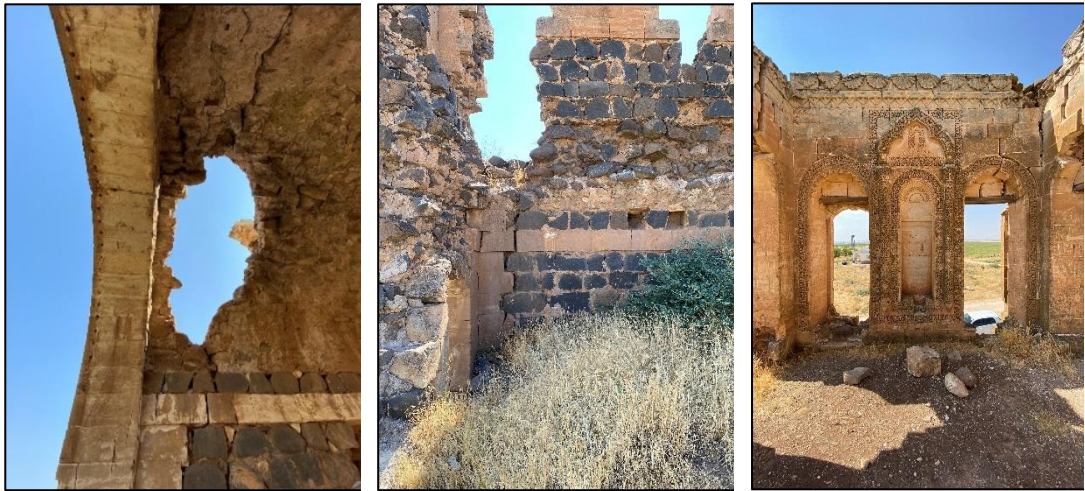
Şekil 4.48 Yapıda meydana gelen yapısal açılmalar
