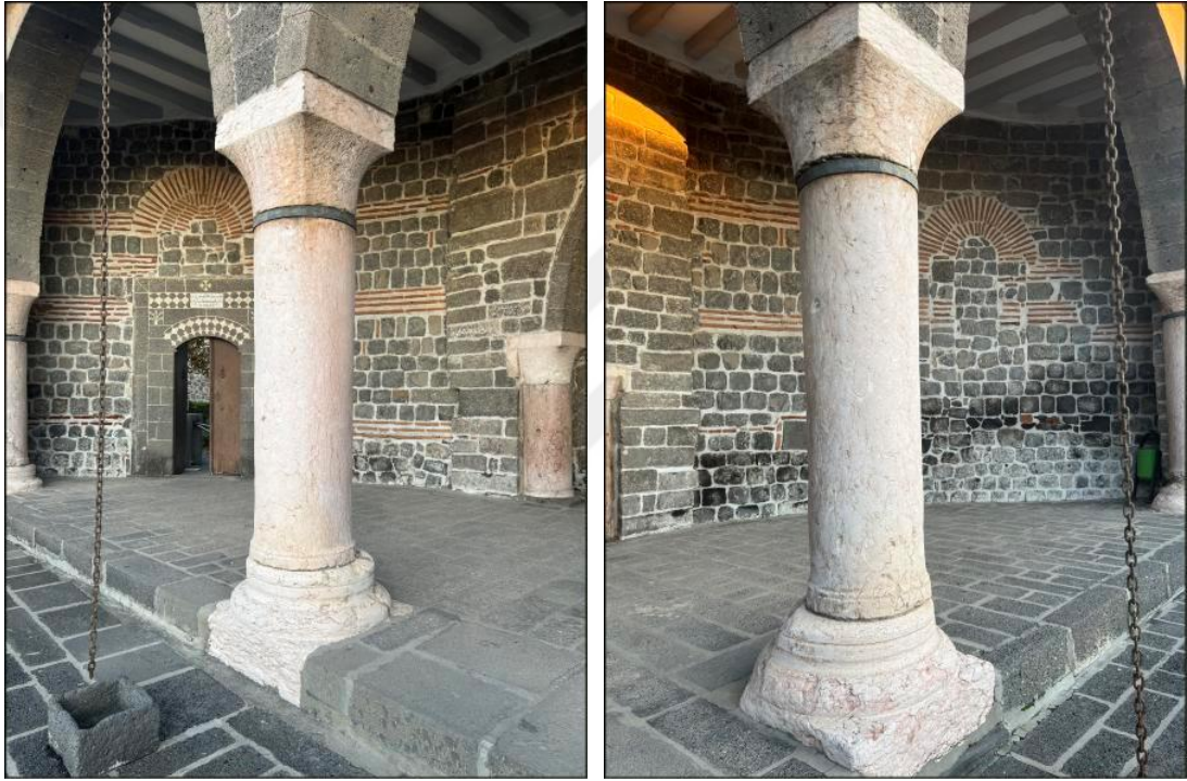
Şekil 3.47 Narteks bölümünde bulunan sütunlarda oluşan eksen kaymaları
