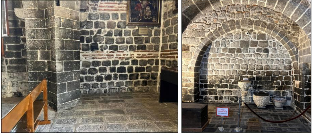
Şekil 3.52 Meryem Ana Kilisesi ve Mor Yakup Kilisesi bölümü duvarlarında oluşan kararmalar
