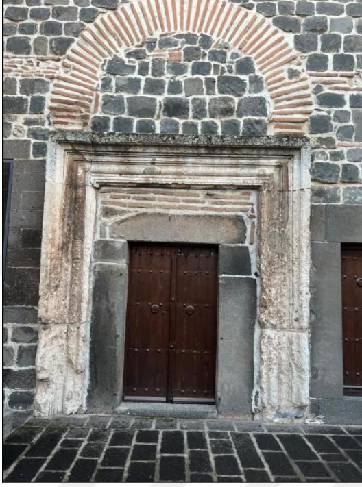
Şekil 3.49 Meryem Ana Kilisesi bölümü 1. avludan giriş kapısı çerçevesindeki kireç taşında oluşan malzeme kayıpları
