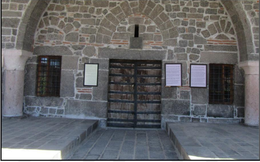
Şekil 3.54 Narteks bölümünün kapı ve pencerelerindeki metallerde oluşan bozulmalar
