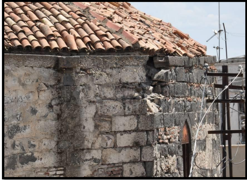
Şekil 4. 82. Kubbe kasnağında görülen taş dökülmeleri(2013)
