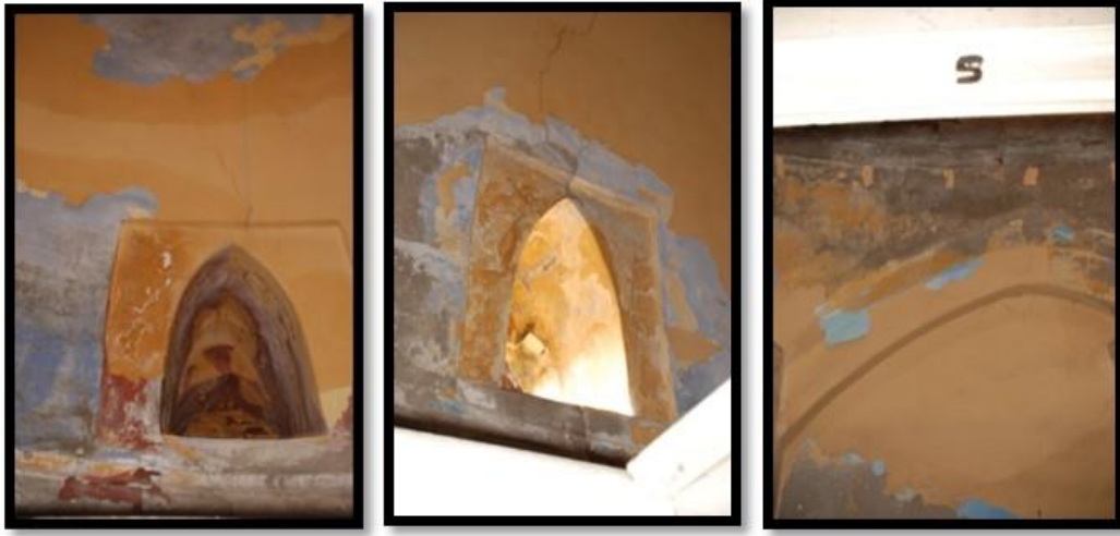
Şekil 4. 102, Şekil 4. 103, Şekil 4. 104. Soğukluk (Z04) üzerini örten kubbede oluşan çatlaklar
