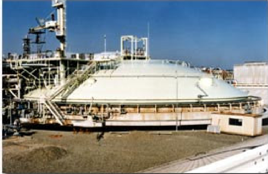
Resim 9.4. Çift duvarlı metalik konstrüksiyonlu LNG depolama tankı
