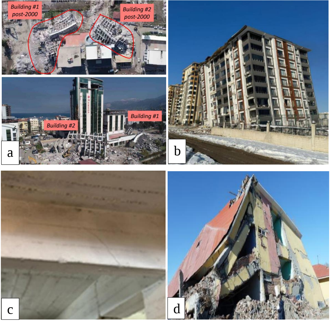
Şekil 1. 2. a)Burulma Düzensizliği Nedeniyle Çöken İki Bina (Vuran ve diğ, 2025), b) Burulma Sebepli Ağır Hasar Alan Bina (Akbaş ve diğ, 2023), c) Betonarme Kiriş Elemanda Burulma Çatlakları (Canpolat ve diğ, 2023), d) Burulma Etkisi İle Yıkılan Okul Binası (Doğan ve diğ, 2013)
