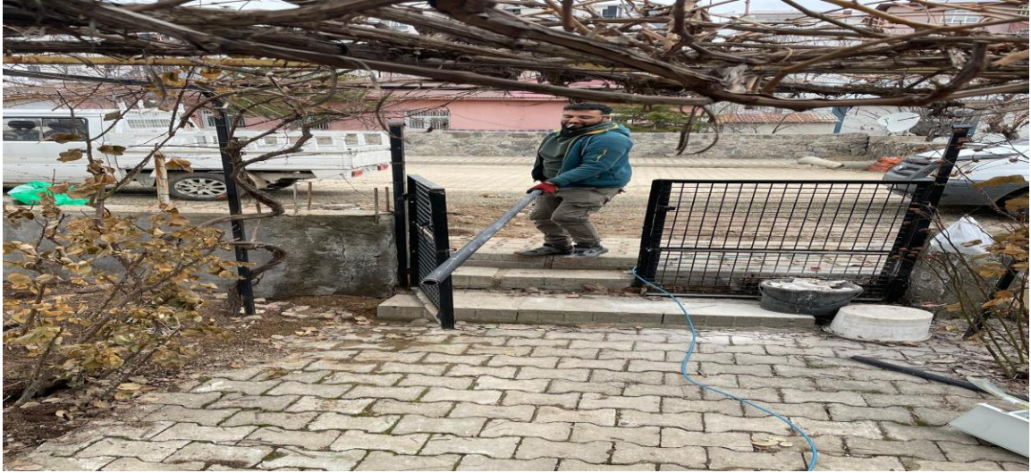
Şekil 1.6. Doğalgaz tesisat işleminde uygun olmayan faaliyet örneği (Tunç, 2024)
