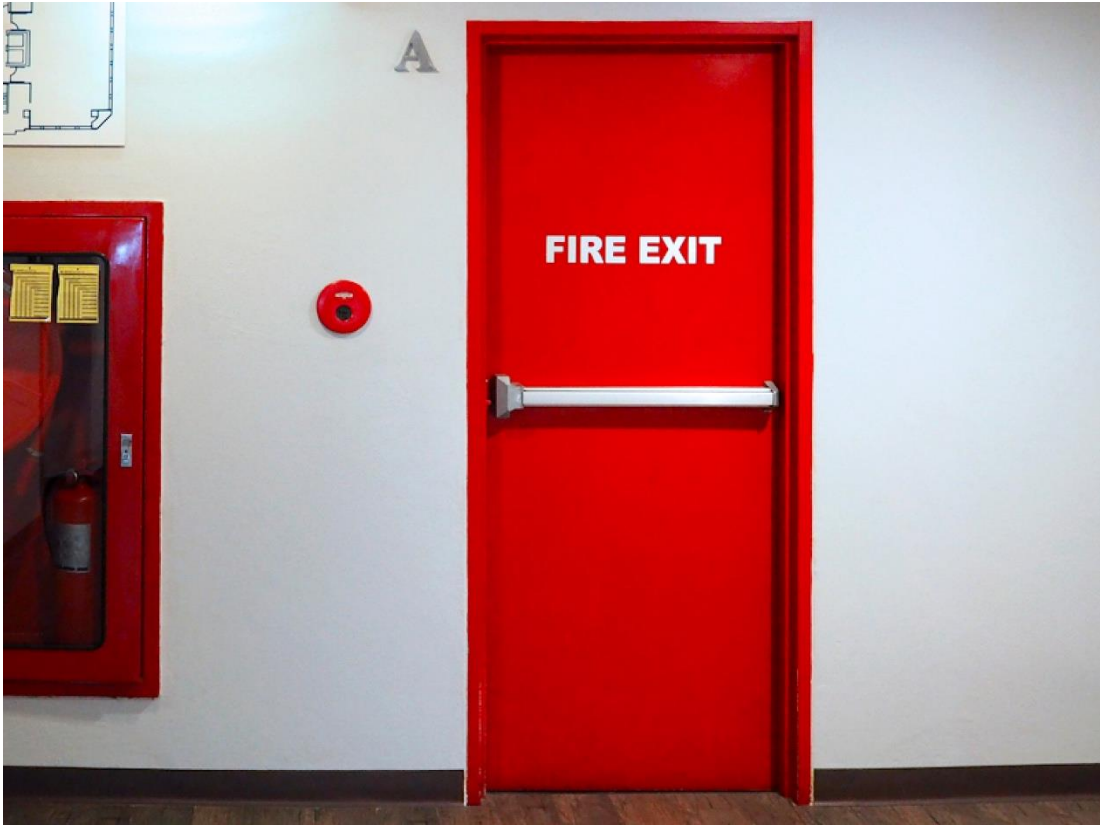
Şekil 14. Acil Durum Kapıları
