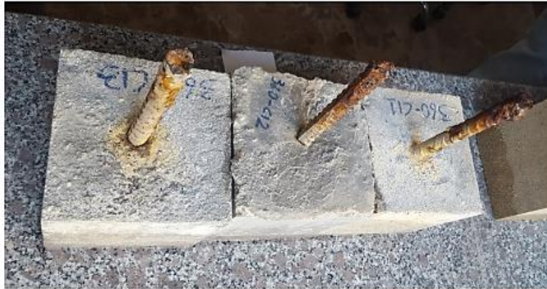
Resim 4.10 28, 180 ve 360 gün sonunda donatıda meydana gelen korozyon
