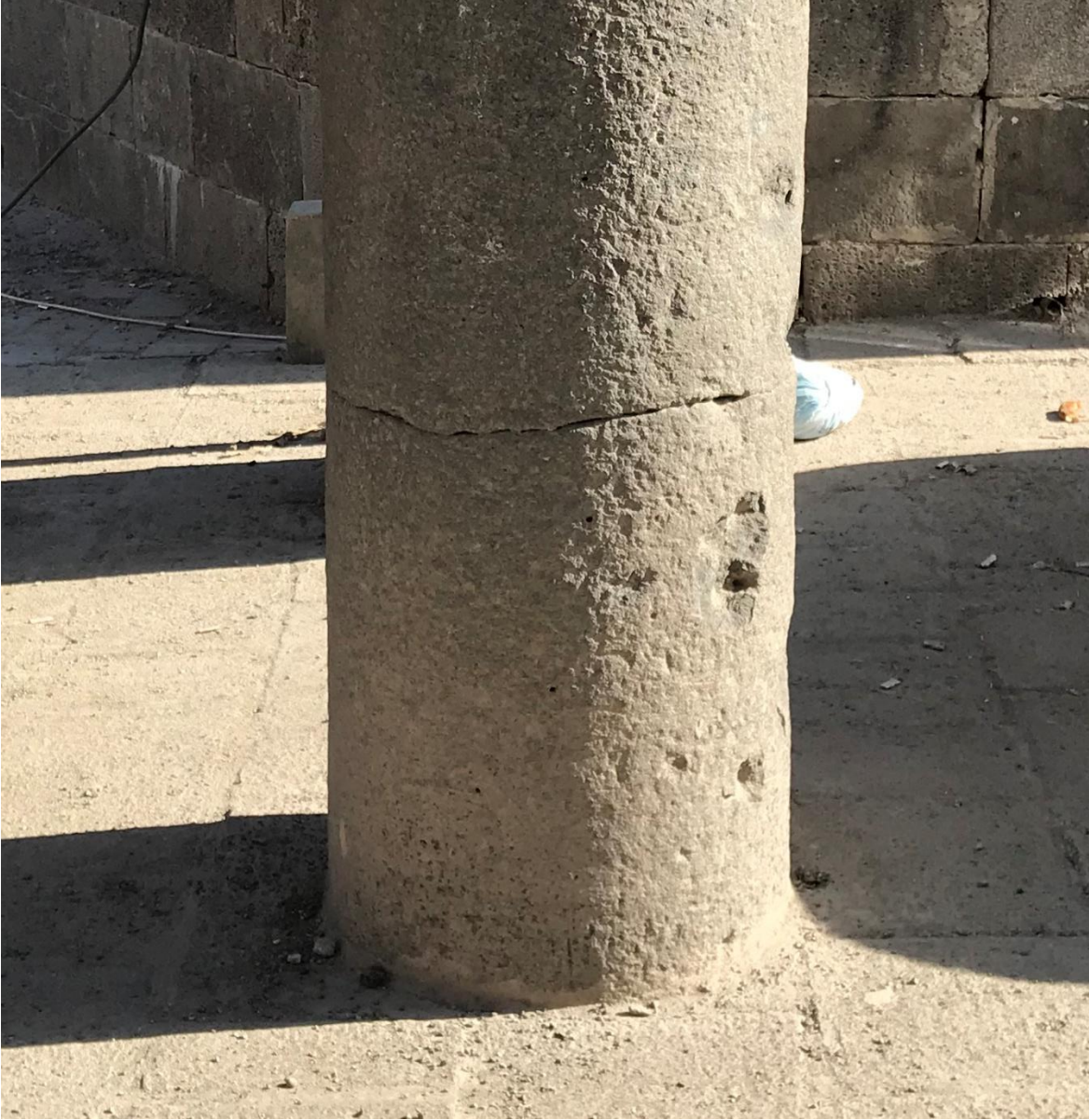
Şekil 4.15. 1 nolu sütunda bulunan lateral çatlak.
