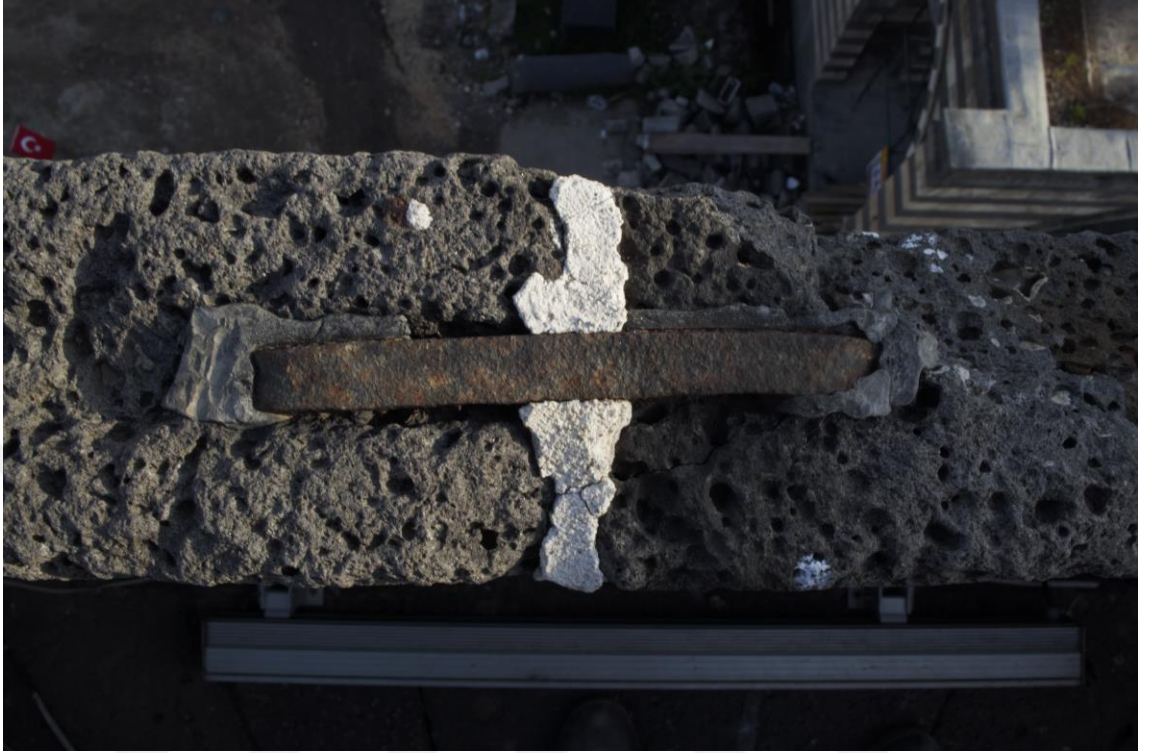
Şekil 4.39. Parapet duvarda bulunan kurşun kenet.
