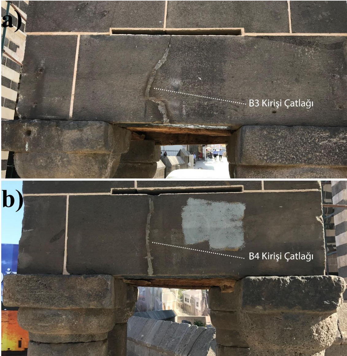
Şekil 4.18. Kirişlerde bulunan yapısal çatlaklar: a) B3 kirişindeki çatlak, b) B4 kirişindeki çatlak.
