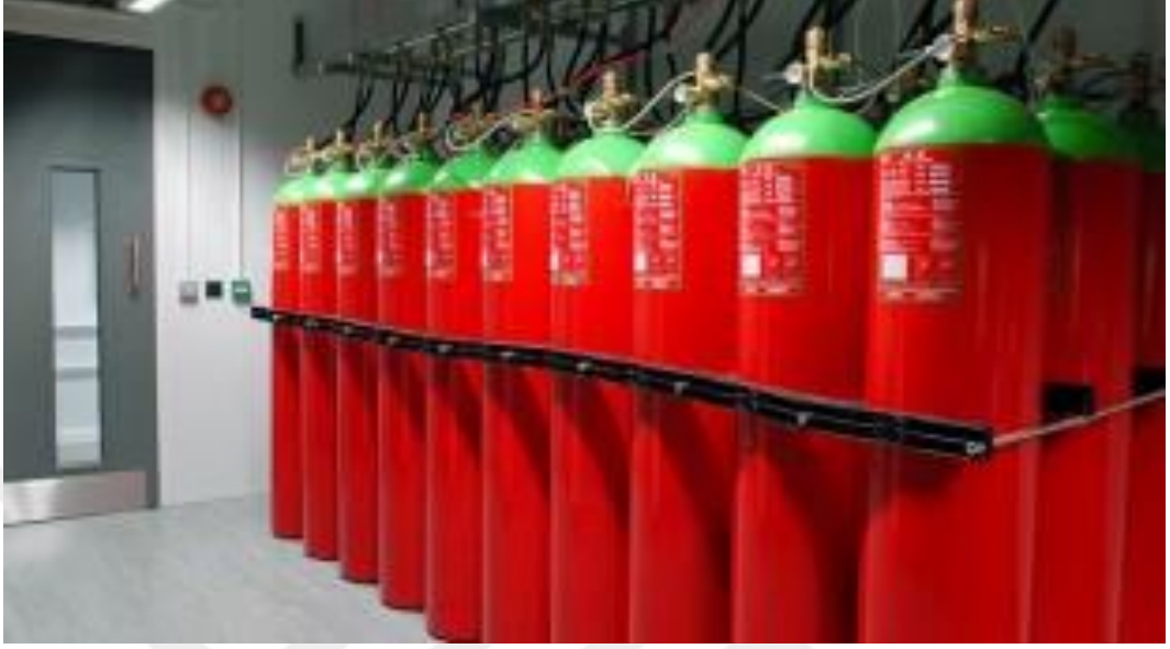
Resim 3.9. Gazlı söndürme sistemleri
