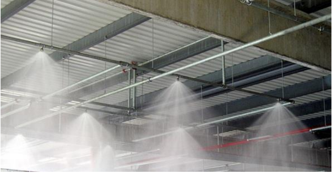
Resim 3.6. Sprink yangın söndürme sistemleri (URL - 23).
