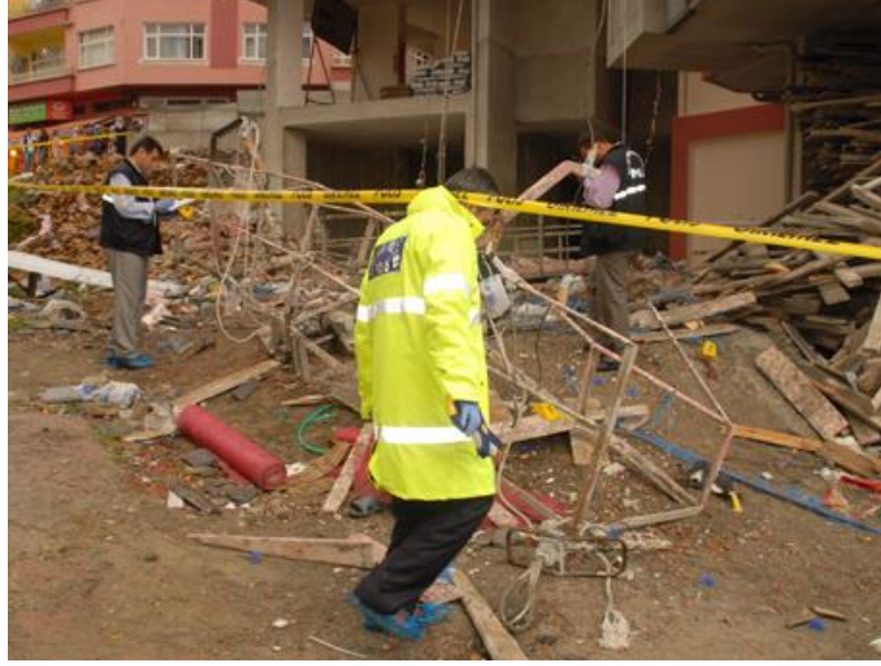
Şekil 1.22. Rize’de iskele halatı kopması sonucu 2 Ölü, 1 Yaralı. (Url_6)
