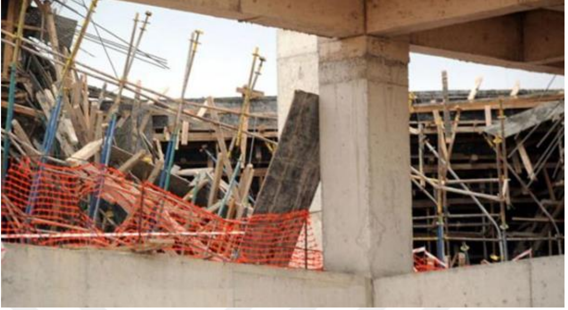
Şekil 1.26. Antalya'da TOKİ' nin yaptırdığı spor salonu inşaatında beton dökümü sırasında iskele çöktü, 4 işçi yaralandı. (Url_10)
