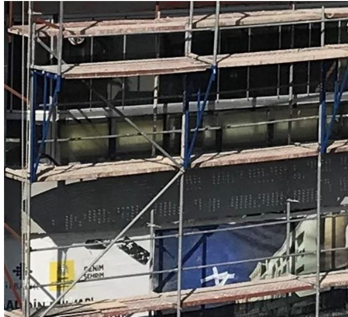
Şekil 1.18. H tipi iskele konsol (Alaaddin bulvarı cephe rehabilitasyonu 2.etap Zafer meydanı kibrit binası)
