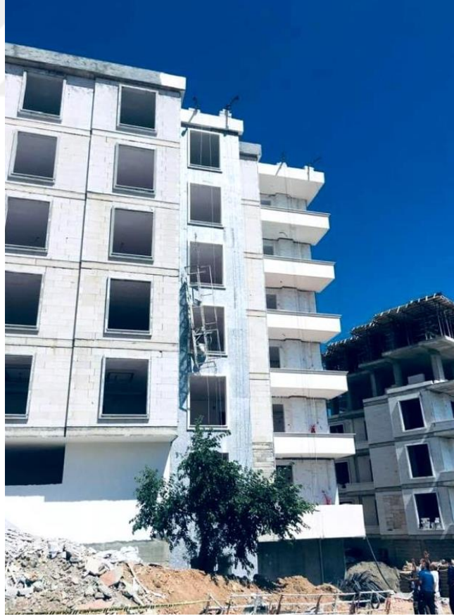
Şekil 1.27. Gaziantep' te 6 katlı bina inşaatının 5. katında çalışan 4 işçi rüzgârın etkisiyle dengesini kaybederek iskeleden düştü. İşlerden ikisi hayatını kaybederken 2 işçi ise ağır yaralandı. (Url_11)
