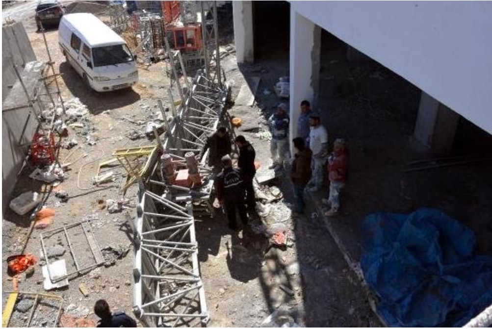
Şekil 1.25. Kahramanmaraş'ta sıva ustası iskelenin çökmesi sonucu hayatını kaybetti. (Url_9)
