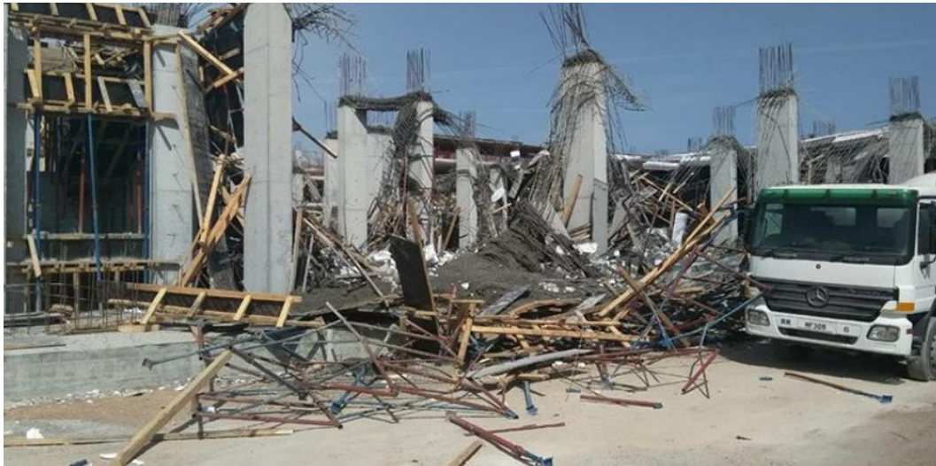
Şekil 1.21. Makenzi Plajında kalıp altı iskele çöktü, 5 işçi yaralandı! (Url_5)
