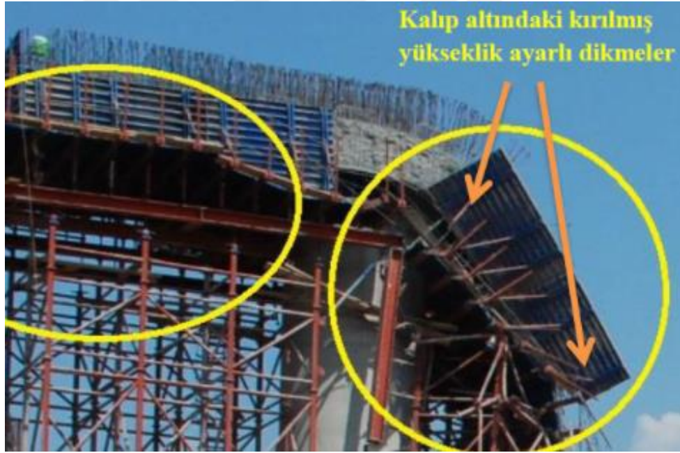
Şekil 1.23. İzmir -Çanakkale otoyolu Koyundere Mevkisi’ndeki viyadük inşaatında iskele çöktü,4 ölü.(Url_7)
