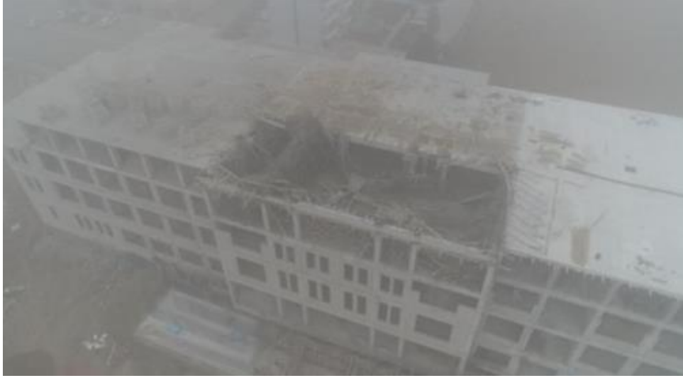
Şekil 1.24. Ankara'da inşaat halindeki okulun 4. katında iskele çökmesi sonucu 1 kişi öldü, 1 kişi yaralandı. (Url_8)
