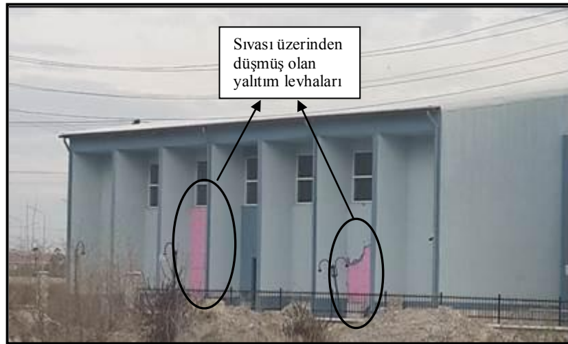
Resim 5.4 Yalıtım levhası üzerinden sıvası düşmüş bir yapı.
