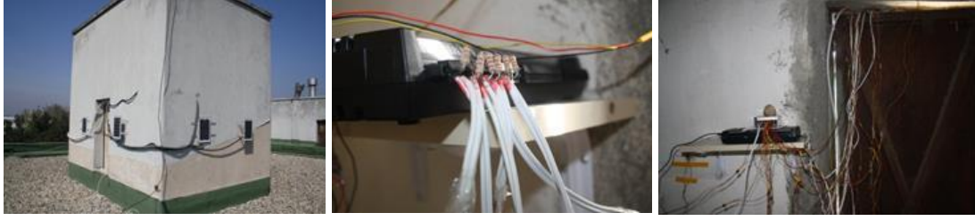
Şekil 5.7 : Binanın perspektif görünüşü, veri kaydedici ve kablolar.
