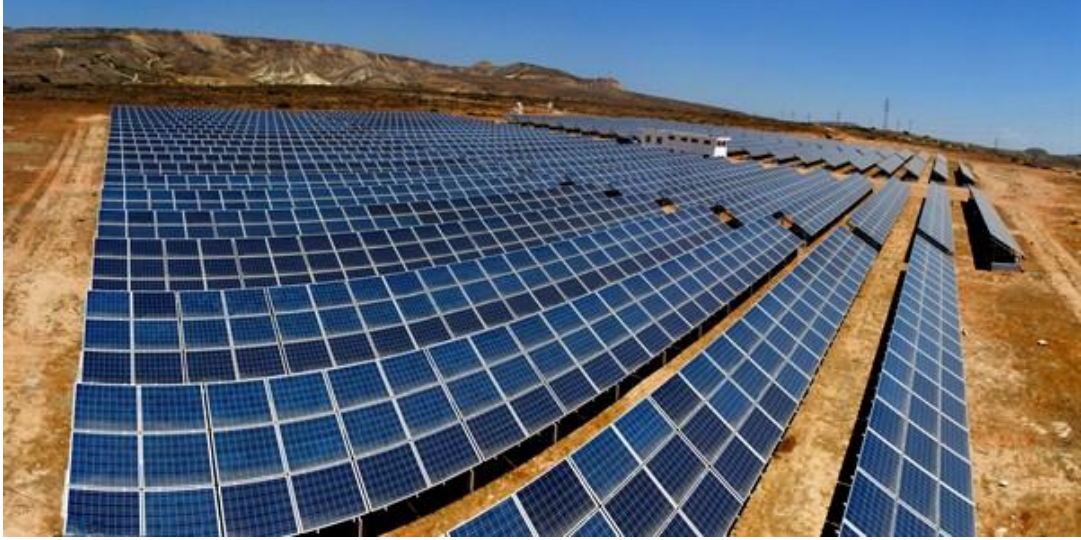
Şekil 2.5 : KKTC’de bulunan, Lefkoşe Güneş Enerjisi Santrali [20].
