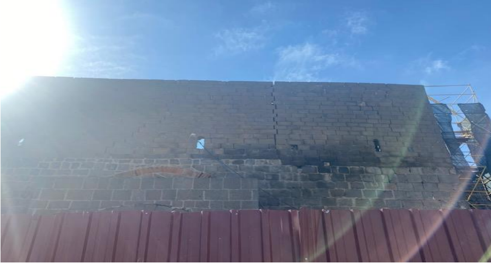
Görsel 1. Diyarbakır Surları'nın Urfa Kapı olarak adlandırılan kısmında deprem sonrası meydana gelen yarık (Orijinal, 2023).
