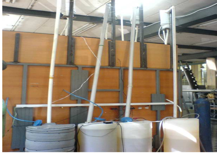
(b) Tesisatın arkasındaki su depoları
