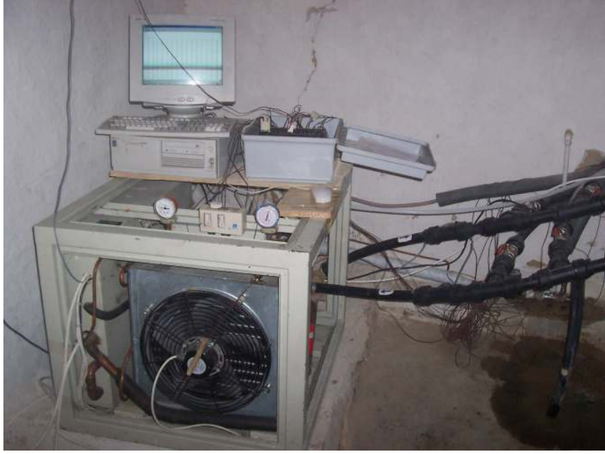
Şekil 3.26. Isı pompası sisteminin görünümü
