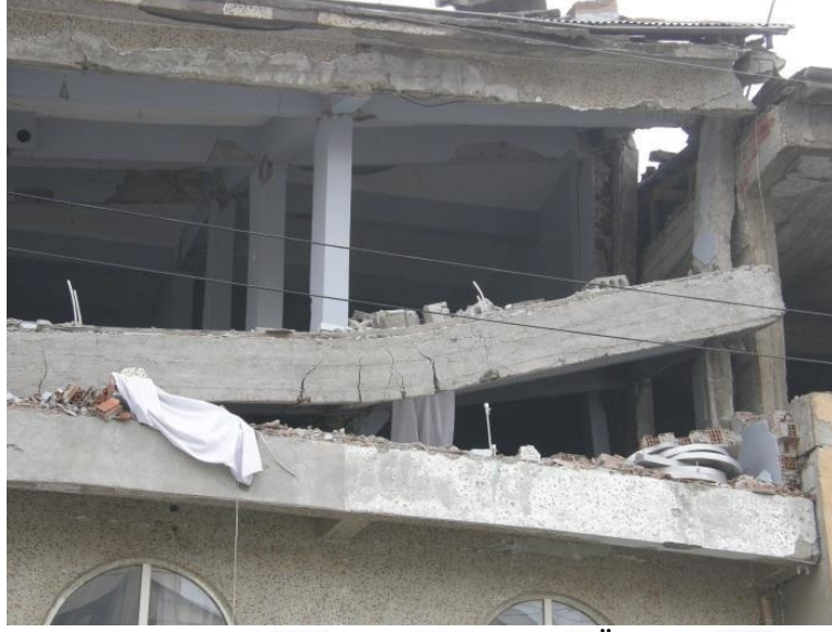
Şekil 2.12. Döşeme-Kolon çarpışması (Önen vd. 2011)
