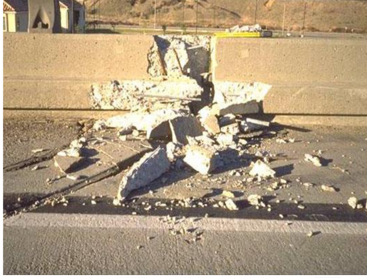
Şekil 2.3. Northridge depremi sonrası hasar örneği
