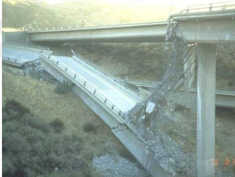
Şekil 2.4. Northridge depremi sonrası hasar örneği
