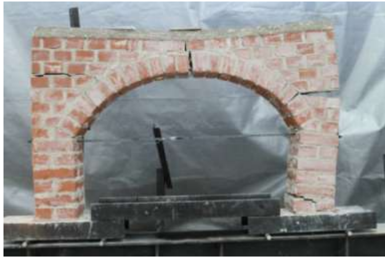
Şekil 3.30: Model-4 deney numunesinin göçme sonucundaki hali.
