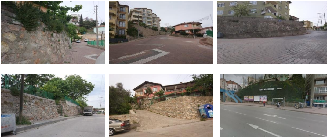
Şekil 4.5. Yenidoğın Mahallesi'ndeki duvarlardan örnekler
