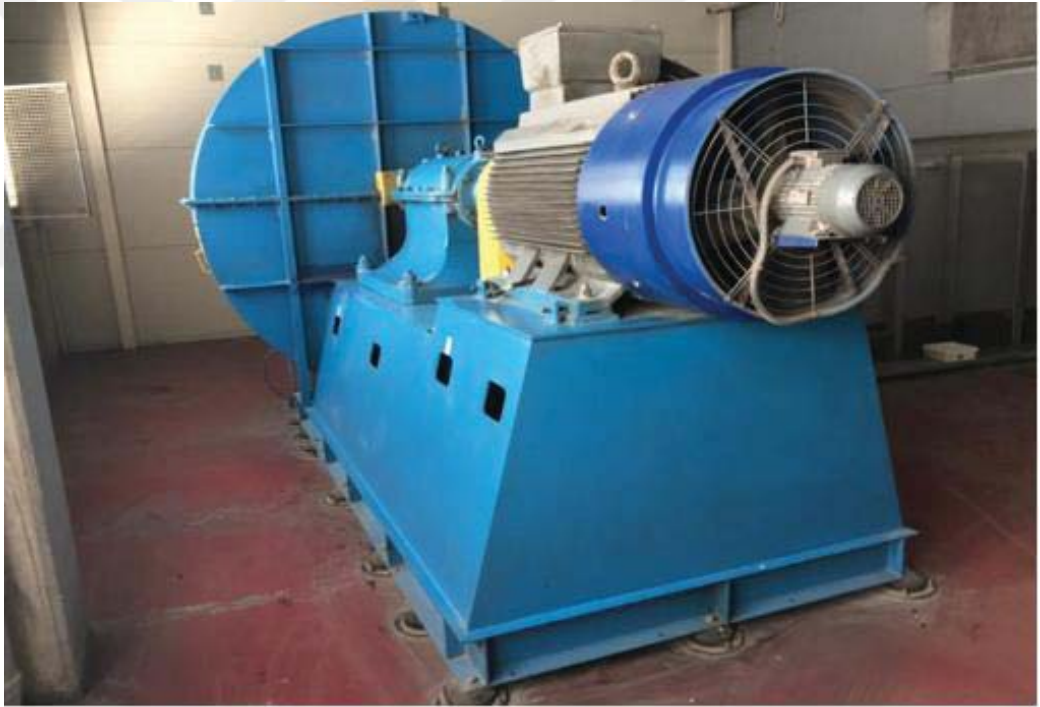
Şekil 4.11. Quench Fan Motoru Görünümü.
