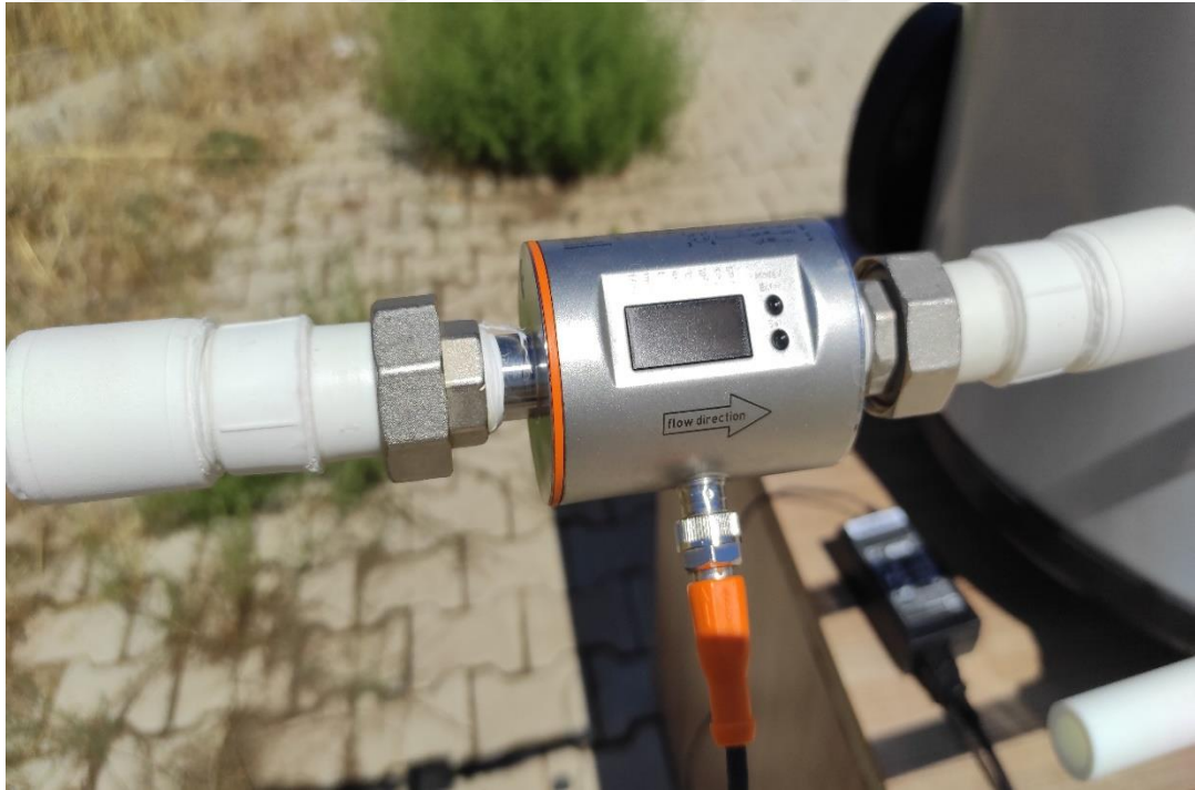
Şekil 3. 7 Ifm DN 15 elektromanyetik debimetre
