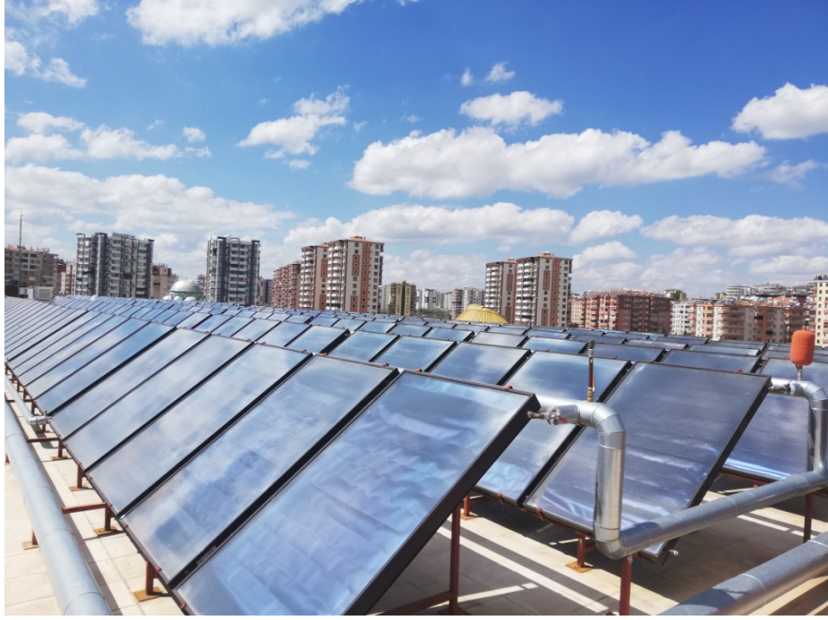
Şekil 1.21. Düzlemsel güneş kolektörleri
