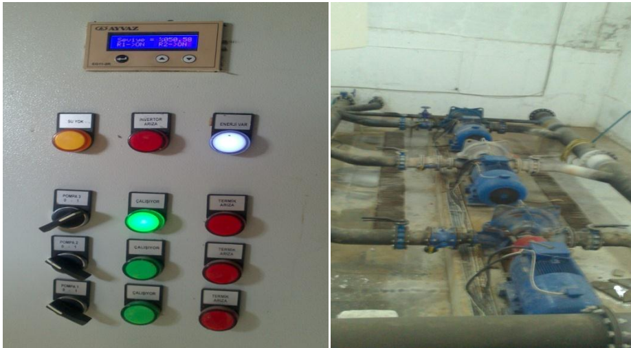
Fotoğraf 2.2. Ege Üniversitesi kullanma suyu depolama ve pompa istasyonu kontrol paneli ve yaşlandırmalı kullanılan pompalar (orijinal).
