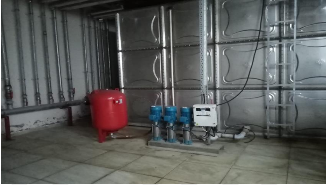
Şekil 3.14. İİBFkazan dairesinde bulunan temiz su sistemleri
