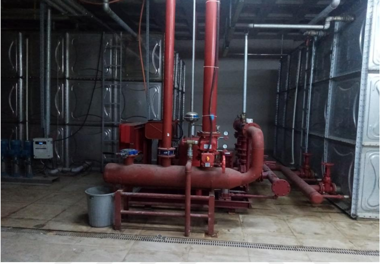
Şekil 3.13. İİBFkazan dairesinde bulunan yangın sistemleri
