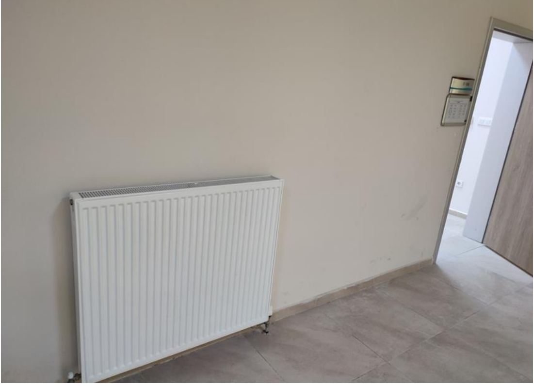
Şekil 3.5. Mühendislik fakültesi bina içerisinde kullanılan radyatörler
