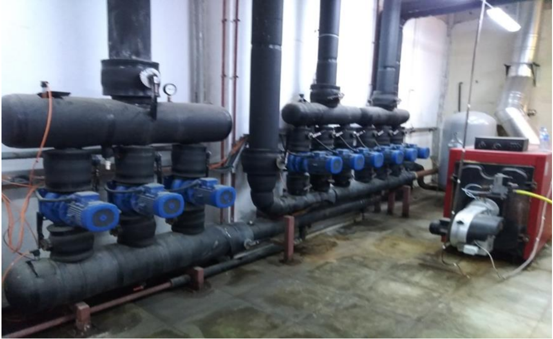
Şekil 3.16. Hukuk fakültesi kazan dairesinde bulunan ısıtma sistemi ve pompalar
