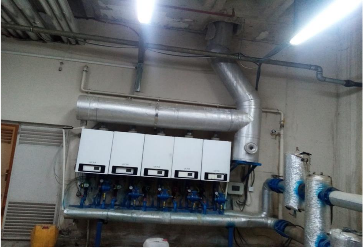
Şekil 3.11. İİBFkazan dairesinde bulunan kaskad sistemi ve pompalar
