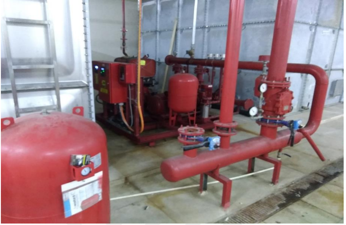
Şekil 3.8. Mühendislik fakültesi yangın tesisatına ait sistemler
