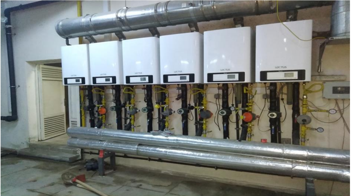
Şekil 3.2. Mühendislik fakültesi kazan dairesi Kaskad sistemi
