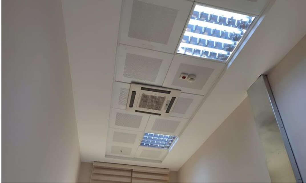
Şekil 3.7. Mühendislik fakültesi VRF soğutma sistemine ait iç üniteler
