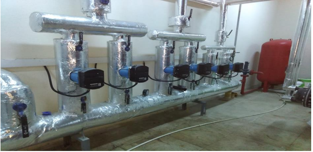
Şekil 3.3. Mühendislik fakültesi kazan dairesi pompa sistemi
