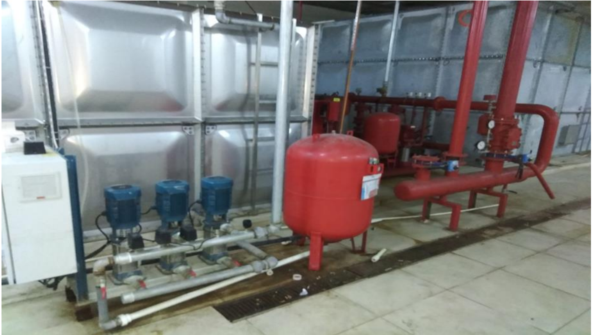
Şekil 3.9. Mühendislik fakültesi temiz ve pis su tesisatına ait sistemler
