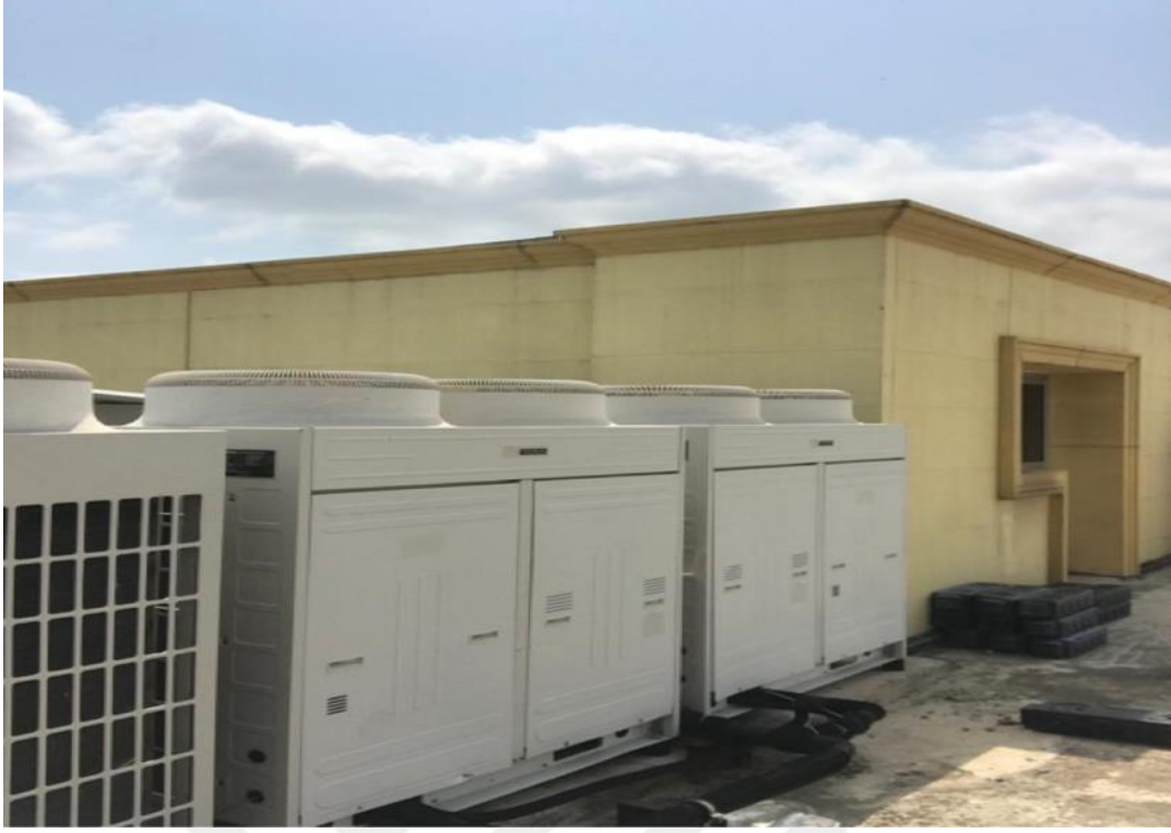
Şekil 3.6. Mühendislik fakültesi VRF soğutma sistemine ait dış üniteler
