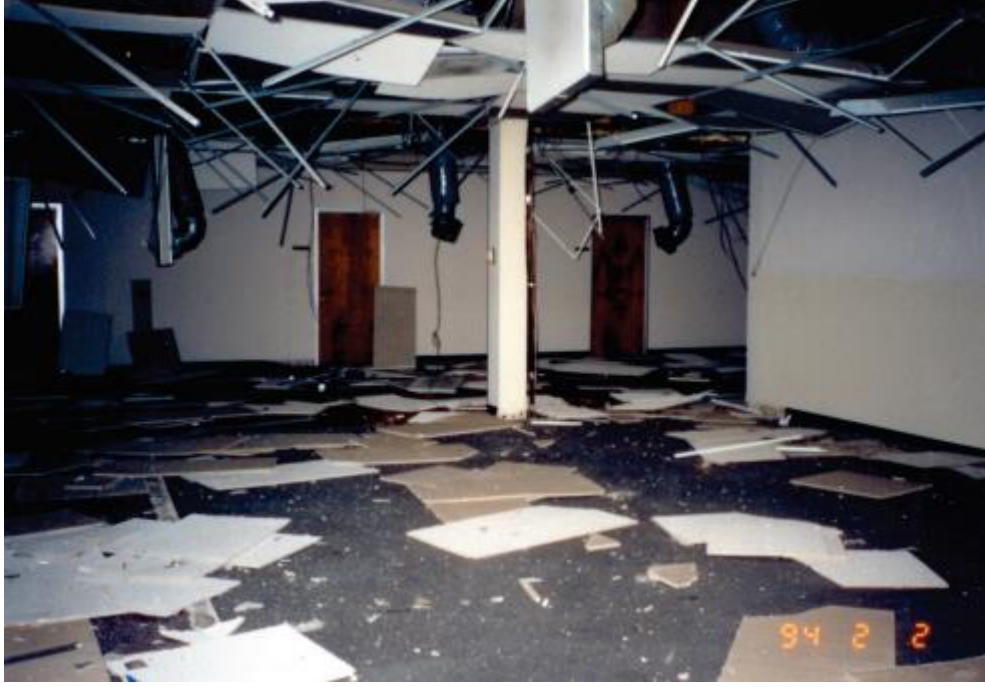
Şekil 3.1. Deprem sırasında hasar görmüş asma tavan (FEMA, 2012).
