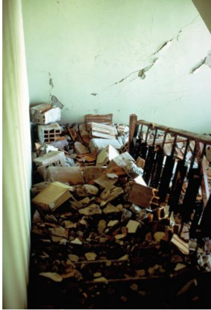
Şekil 3.2. Yıkılan duvar nedeniyle çıkış yollunun kapanması (FEMA, 2012).
