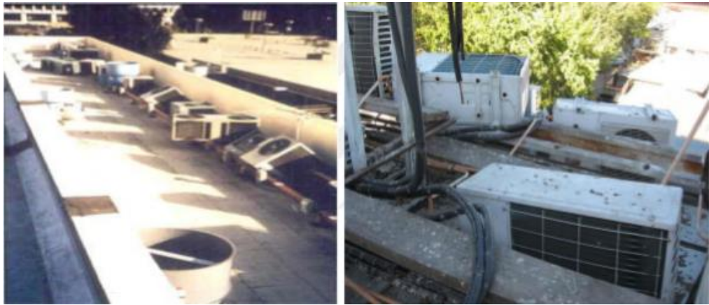
Şekil 3.4. Deprem nedeniyle çatı ünitelerinin düşmesi (FEMA, 2012).
