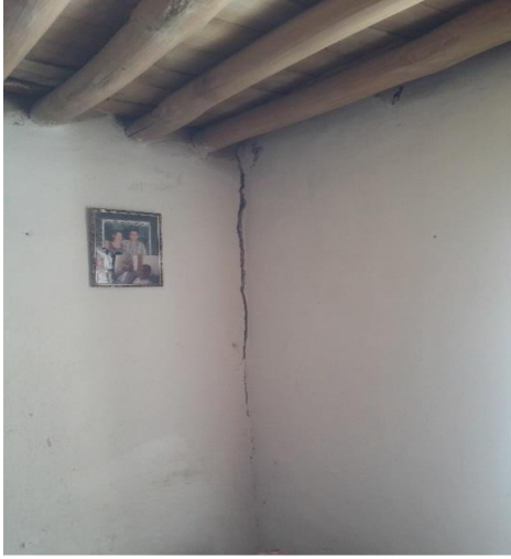
Şekil 3.18 Boyuna çatlakların içten görünüşü
