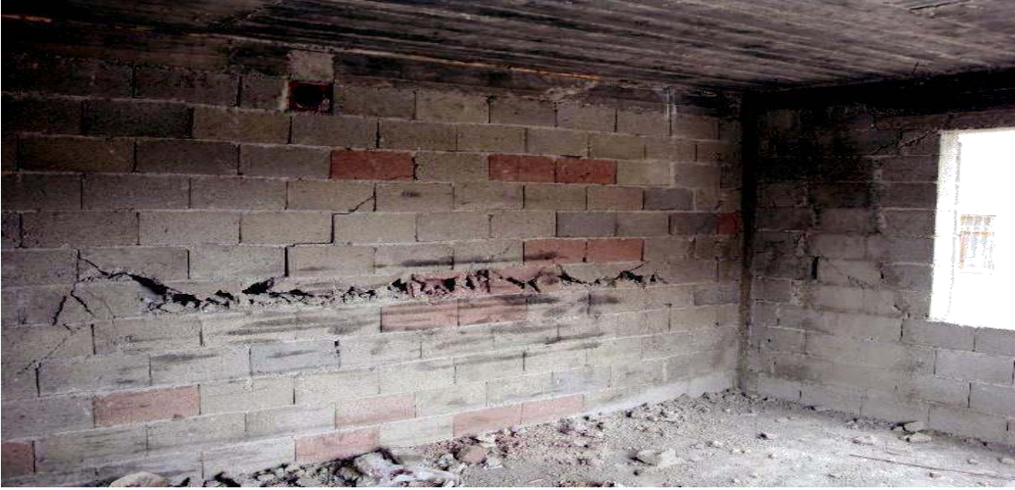
Şekil 3.5. Taşıyıcı yığma duvar çatlakları
