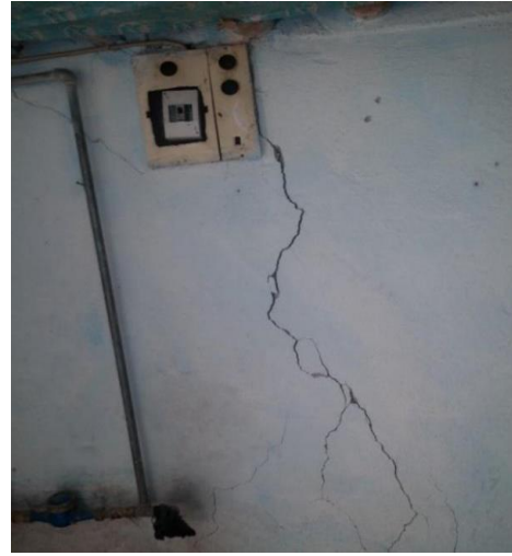
Şekil 3.19 Bağlantısı yetersiz duvarlardaki boyuna çatlaklar
