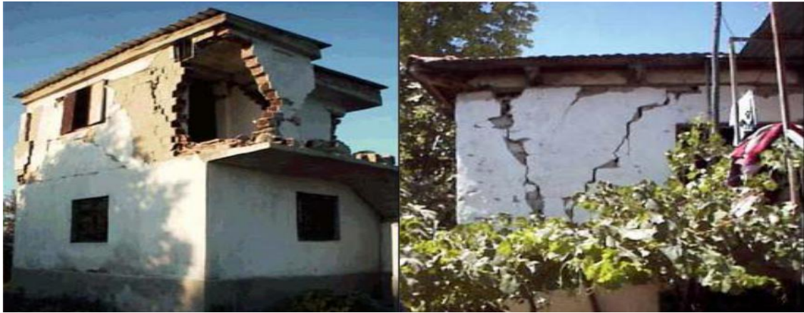
Şekil 3.6 Yığma yapılarda görülen farklı hasarlar (Sucuoğlu,1997)
