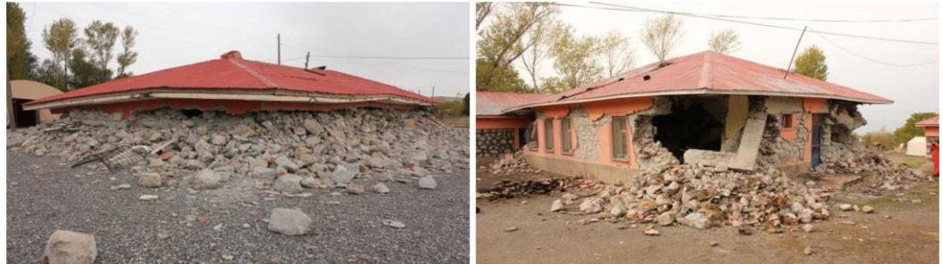
Şekil 3.17 Alaköy (solda) ve Dağönü (sağda) yıkılmış ve ağır hasar görmüş doğal taş okul binaları
