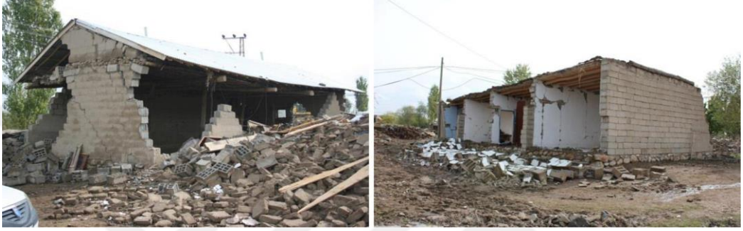
Şekil 3.15 Beton taş duvar binalarındaki hasarlar
