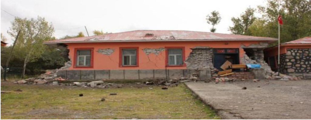
Şekil 3.12 Ağır hasar görmüş bir okul binası
