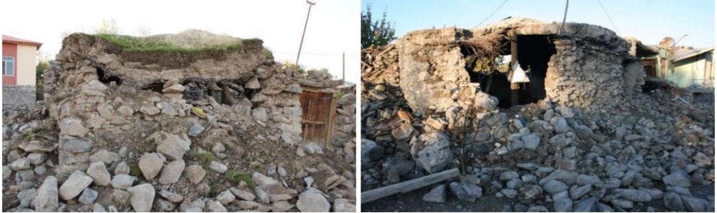
Şekil 3.16 Yaylıyaka'da yıkılmış doğal taş duvar binaları. Kerpiç harç kullanımı (solda), taş duvar kirişi yok (sağda).
