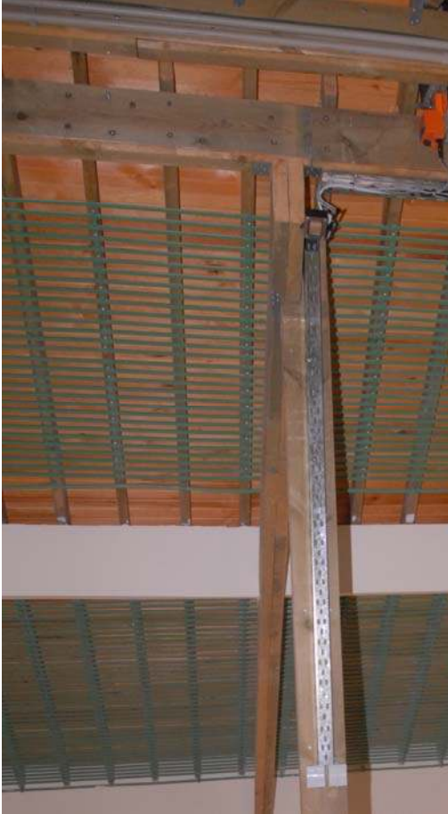
Şekil 4.91 Binada dolaşan sabit ısı boruları
