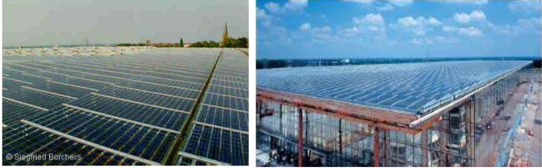
Şekil 4.79 Çatıdaki Fotovoltaiklerin Görünümü
