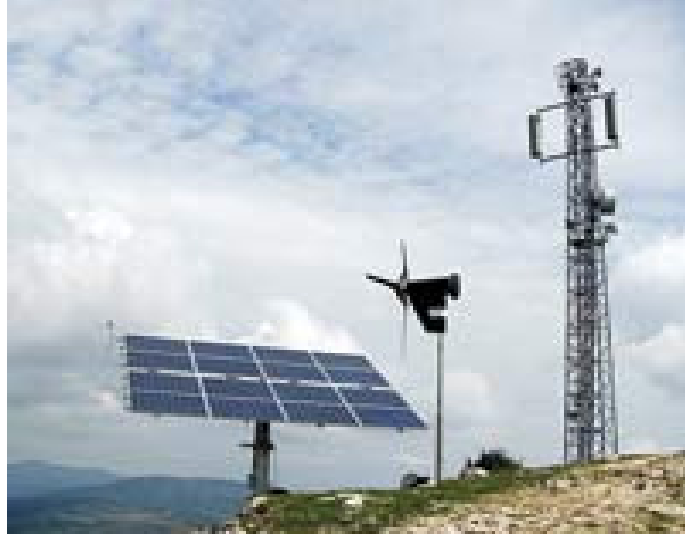
Şekil 3.27 Fotovoltaik panel ile çalışan gsm baz istasyonu. ( http://www.solar-santral.com/menu_detay.asp?id=436 )
