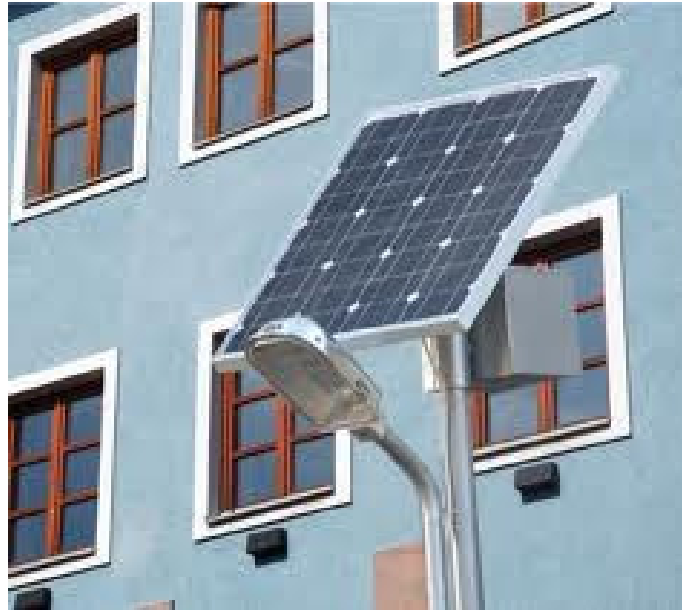
Şekil 3.26 Fotovoltaik paneller ile çalışan sokak aydınlatma armatürü. ( http://www.elektrosolar.com.tr/60-solar-cadde-sokak-aydinlatma.html )
