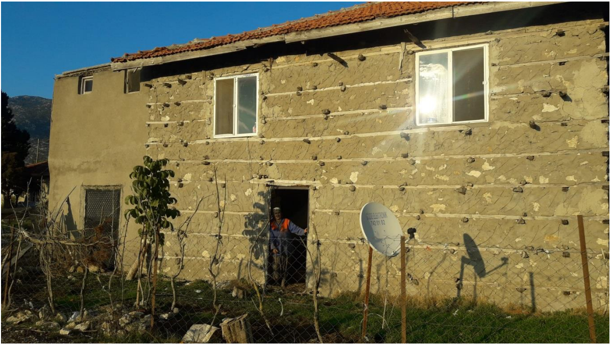
Fotoğraf 5.22 Başlar mahallesinde günümüz inşa malzemeleri ile ek yapı inşa edilerek tarihi dokusu zedelenmiş bir düğmeli ev görünümü (21.11.2020).
