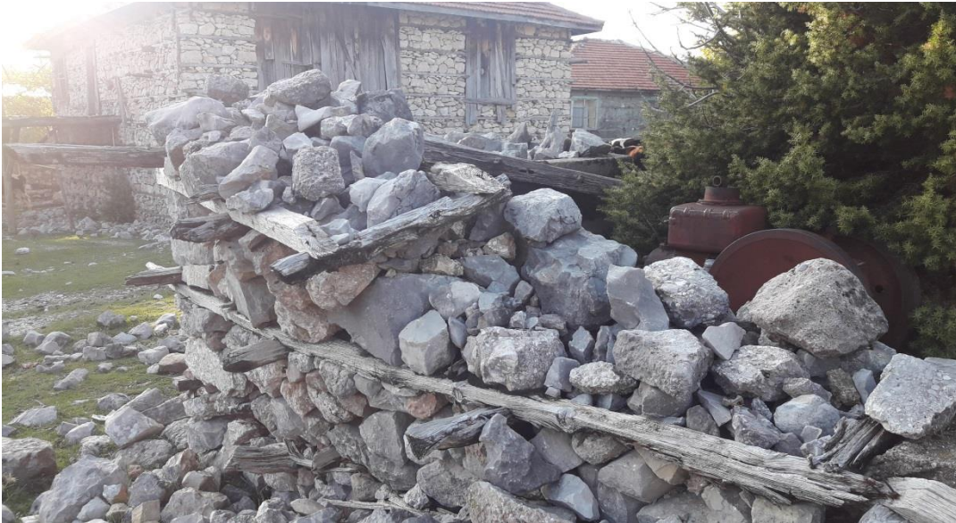
Fotoğraf 5.4 Başlar mahallesinde yıkılan bir düğmeli evin duvar örme tekniğinden bir örnek (25.11.2020).
