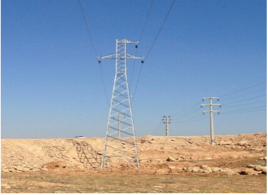
Şekil 3.5. Havai Orta Gerilim Hattı
