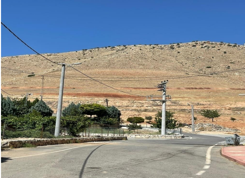
Şekil 3.6. Havai Alçak Gerilim Hattı
