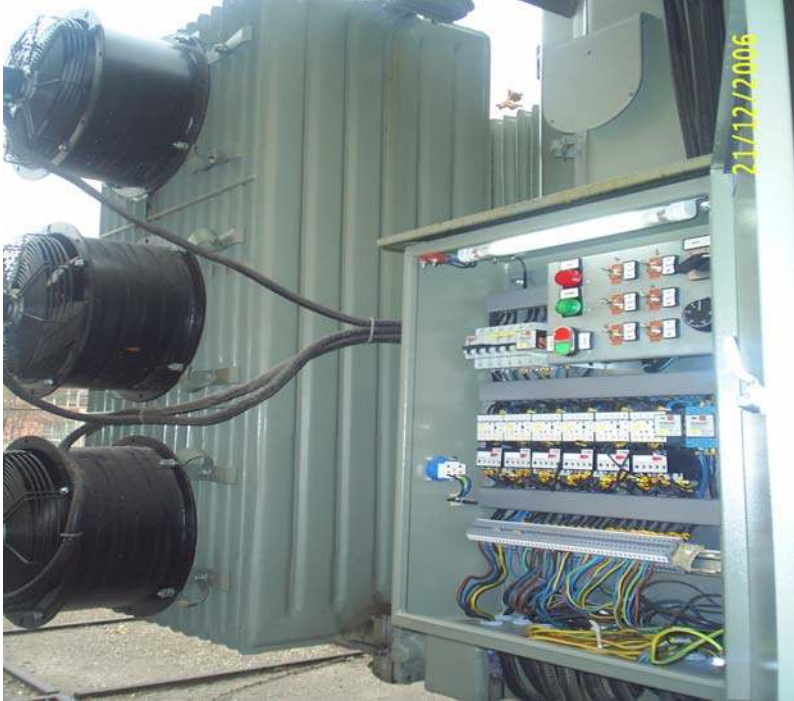
Resim 5.5. Trafonun uzaktan kontrol ile değerlerinin on-line belirlenmesi
