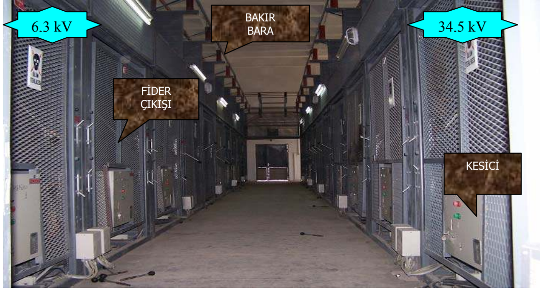
Resim 4.1. Balgat TM'nin 34,5 kV/6.3 kV hücrelerinin bina içi görünüşü
