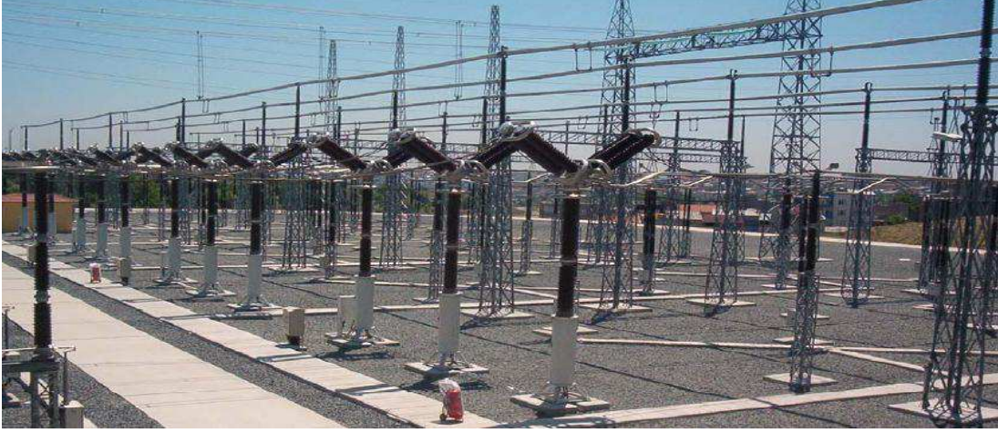
Şekil 2.1. 380 kV açık bir şalt merkezi
