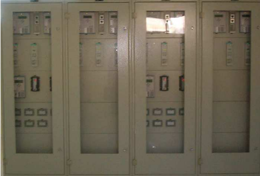
Şekil 2.3. 380 kV röle panosu
