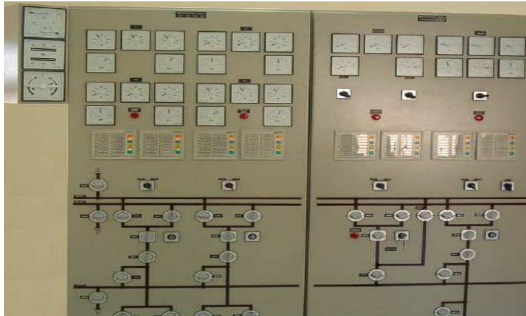
Şekil 2.2. 380 kV kumanda panosu
