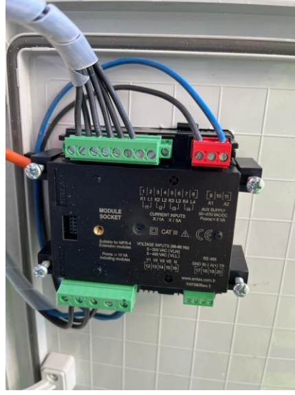
Şekil 4.8. Pano üzeri enerji analizörü montaj görseli
