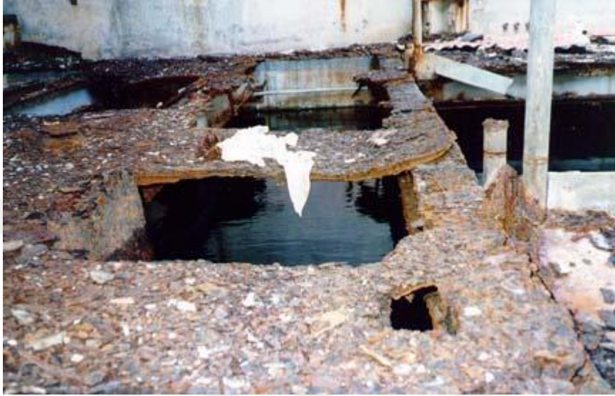
Şekil 2.3: Üniform korozyona uğramış tesis (URL-7, 2024).
