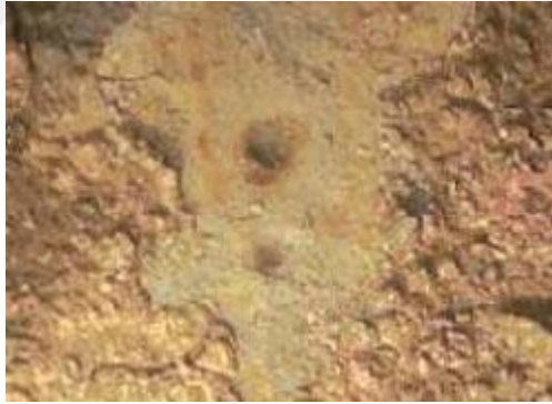
Şekil 2.9: Çukur korozyonu (URL-7, 2024)
