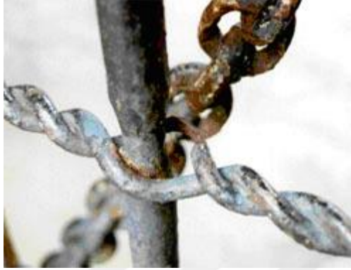
Şekil 2.16: Aşındırma korozyonuna uğramış çit direği (URL-7, 2024).
